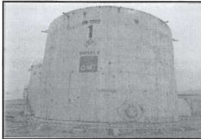
Fotografía N° 1: El tanque N° 1 que se va a abandonar no ha sido retirado.
