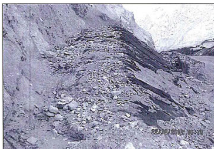
Hallazgo 67: Fotografía N° 73: Residuos de procesos dispuestos en la zona de circunvalación. En un tramo del pie de talud existe un muro de contención, no cuenta con estructuras hidráulicas.
