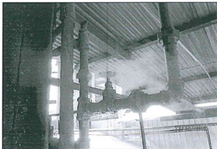
Hallazgo N° 50: Fotografía N° 3: Emisiones fugitivas en válvula ubicada cerca al tostador N° 6
