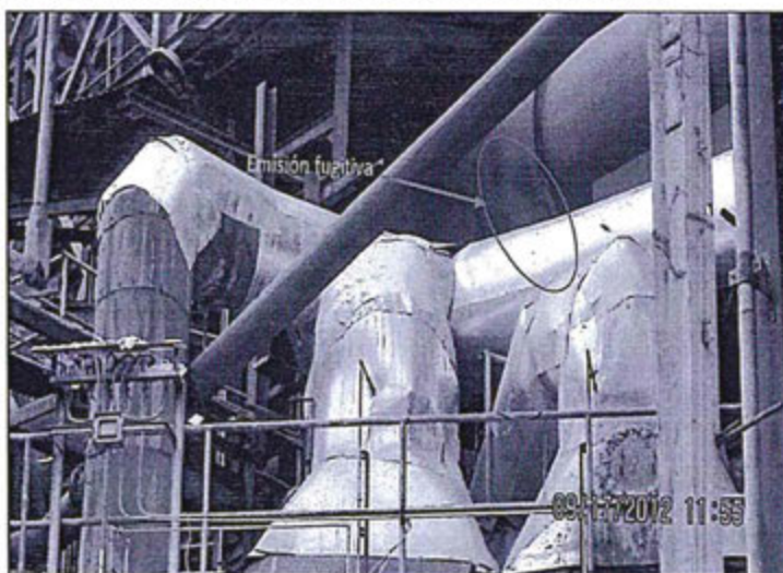
Hallazgo N° 20: Fotografía N° 4: Se observa emisión fugitiva que sale del conducto que se encuentra ubicado en la parte superior del intercambiador caliente del Convertidor Catalítico de la planta de ácido sulfúrico de zinc.
