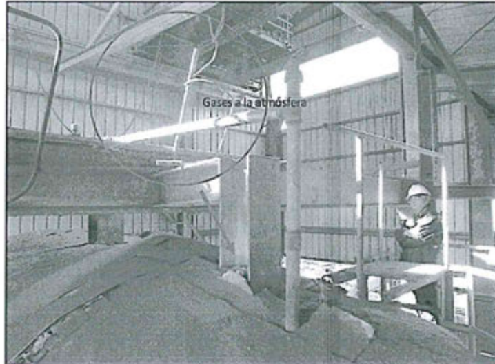
Hallazgo N° 36: Fotografía N° 2: Parte superior del ducto (junto a la viga) hacia la caldera La Mont, donde se observa emisiones fugitivas de gases SO 2 al ambiente.
