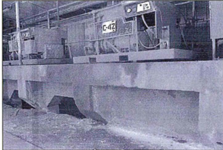
Hallazgo N° 55: Fotografía N° 43: En la zona de compresoras del circuito de Zinc se ha observado derrame de aceites al suelo debido a que no existe un sistema de contención secundaria para colectar los derrames.
