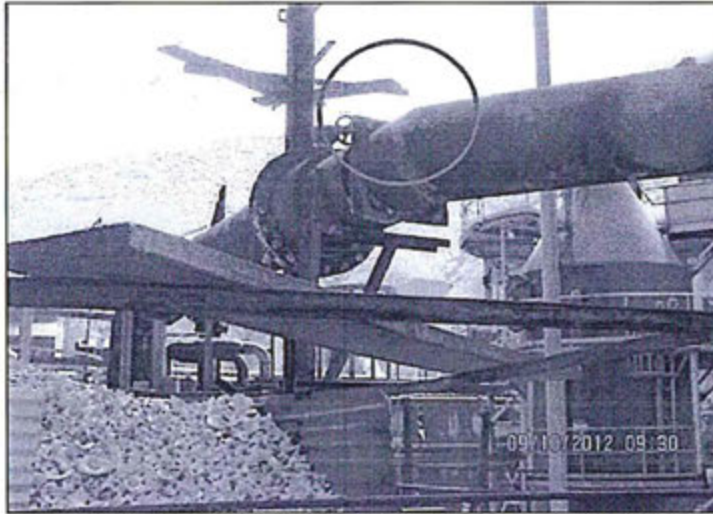
Hallazgo N° 35: Fotografía N° 11: Se observó la emisión fugitiva de SO 3 por el codo del conducto que transporta el gas desde el convertidor catalítico hacia la torre de absorción ubicada en la Planta de Ácido Sulfúrico del Circuito de Zinc.
