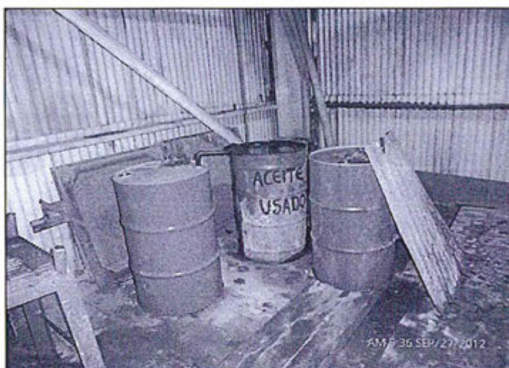
Hallazgo 65: Fotografía N° 17: Al costado del filtro prensa de la planta Hidrometalurgia se encuentran dos cilindros con aceite sin contar con un sistema de contención en caso de derrames, además se tiene un cilindro con aceite usado (residuo peligroso), que se debe retirar a otro lugar
