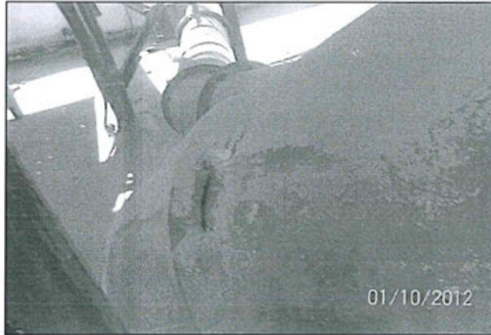
Hallazgo N° 34: Fotografía N° 39: Emisiones fugitivas y por chimenea en la planta de polvo de zinc.
