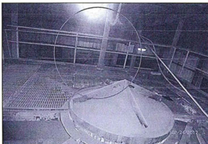
Hallazgo N° 22: Fotografía N° 7: En la parte superior del tostador Lurgi (TLR), se observa emisiones fugitivas de gases de SO 2 al ambiente, situado en el circuito de zinc.
