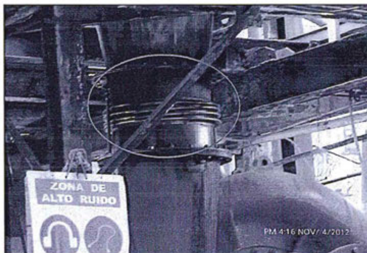
Hallazgo N° 49: Fotografía N° 86: Otra vista de la junta expansiva de la compresora Eliot C-60, donde se observa una rajadura y se aprecia escape de gases SO 2 al ambiente.
