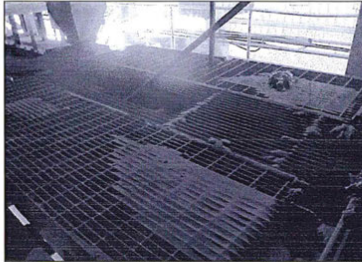
Hallazgo N° 14: Fotografía N° 60: Entre los Redleres 10B1 y 10B2 se ha observado emisiones fugitivas de partículas.
