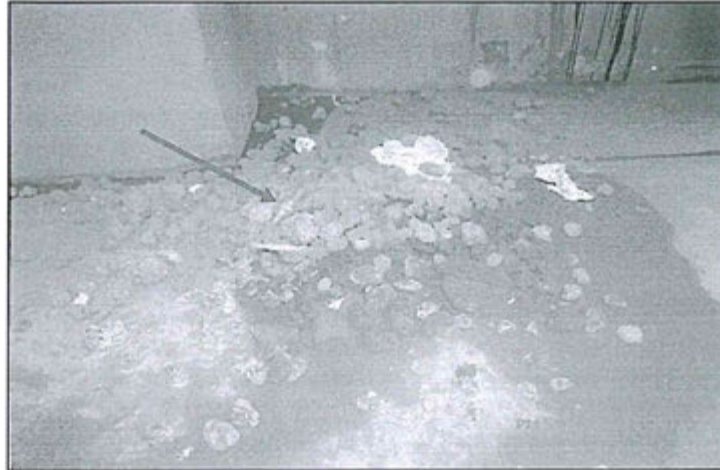
Hallazgo 60: Fotografía N° 18: En la parte baja frente a la tolva auxiliar de esponja de hierro en la planta Zileret, se encuentran residuos sólidos tales como: envases de plástico de gaseosa, saco de plástico, etc., mezclados con la esponja de hierro
