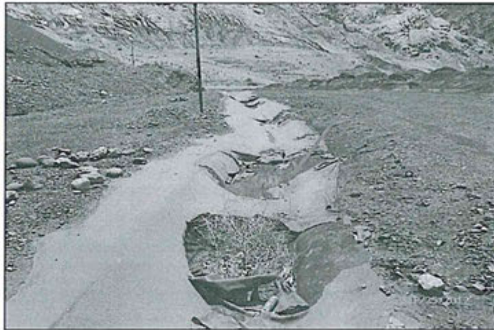
Hallazgo N° 56: Fotografía N° 12: En el canal para aguas de escorrentía de lluvias a un costado de la vía de acceso hacia el depósito de ferritas de Zinc de Huanchán, la geomembrana se encuentra en mal estado (rota) en ciertos tramos y además falta limpieza.
