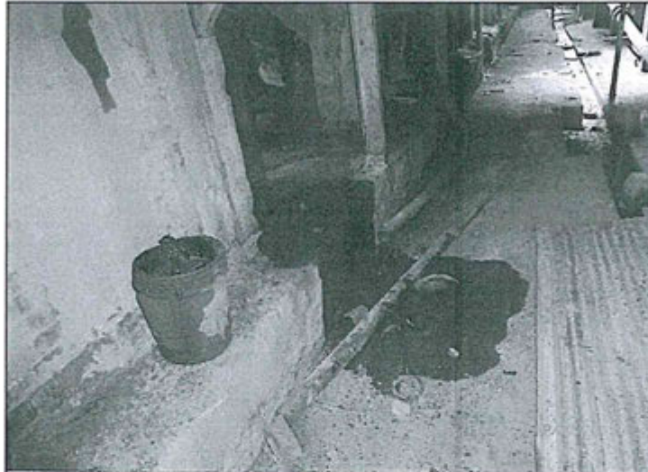
Hallazgo 64: Fotografía N° 4: En la parte posterior de las compresoras de aglomeración, se observa un balde con grasa (residuos peligrosos), aceite derramado en la losa y materiales de mantenimiento, en lugar no establecido.
