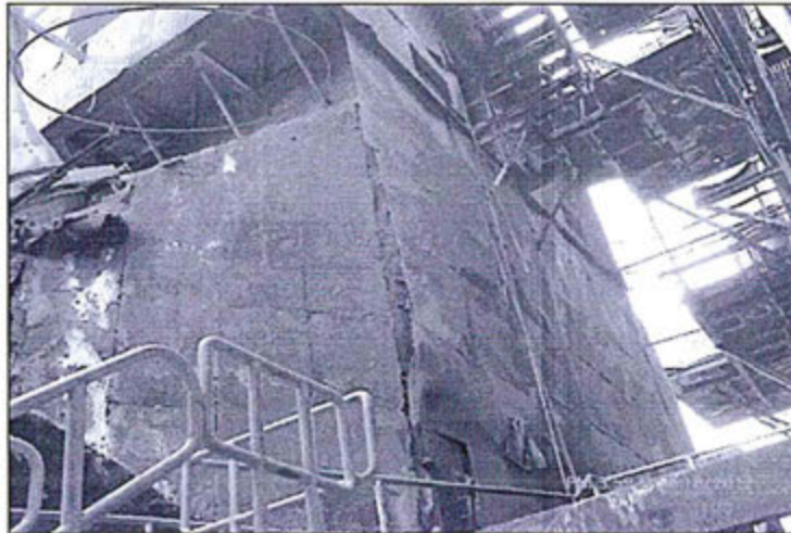
Hallazgo N° 39: Fotografía N° 13: Techo del Hot Cottrell A y B por donde se observa emisiones fugitivas de gases SO 2 al ambiente, que durante la supervisión se siente fuerte el gas en esa zona.
