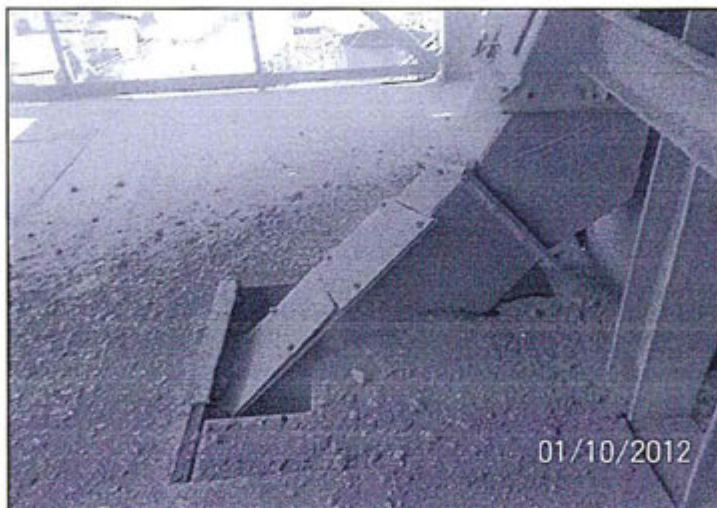
Hallazgo N° 33: Fotografía N° 37: Emisiones fugitivas de partículas en el chute del elevador separador magnético de la planta Zileret.
