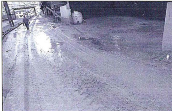
Hallazgo 57 Fotografía N° 15: Debido a la presencia de lluvias, las ferritas de Zinc son arrastradas de su almacenamiento hacia la vía de acceso, formando lodos con el suelo natural.
