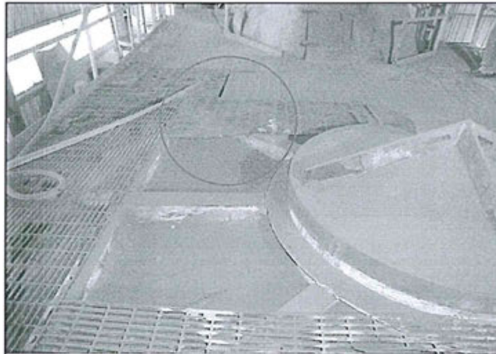
Hallazgo N° 48: Fotografía N° 86: En la parte superior del TLR, lado izquierdo del tapón de seguridad (frente a la viga), se observa escape de emisiones fugitivas de gases SO 2 al ambiente
