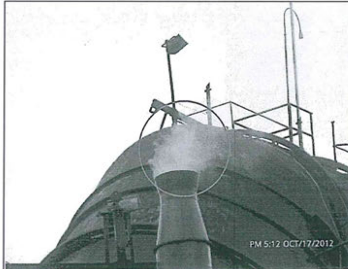
Hallazgo N° 38: Fotografía N° 11: Chimenea vertical que se encuentra acoplado al ducto que conduce los gases hacia la chimenea principal, por donde hay escape de gases de SO 2 al ambiente situado en la planta de ácido sulfúrico del circuito de zinc.
