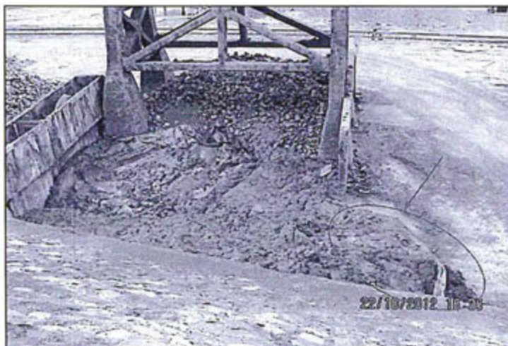
Hallazgo 69: Fotografía N° 80: Depósito de almacenamiento de lodos de Plomo, no está cerrado, no cuenta con estructuras hidráulicas y el almacenamiento incluso se realiza fuera del depósito
