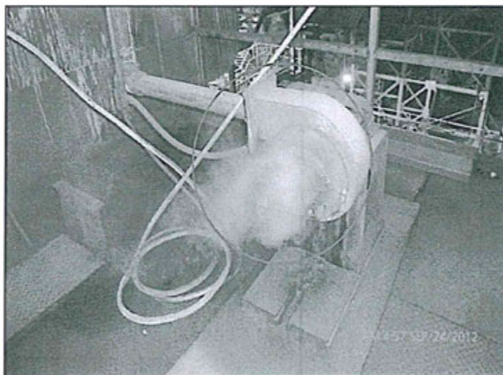
Hallazgo N° 23: Fotografía N° 9: Al costado del ducto de gases que va al Hot Cottrell, se encuentra un ventilador trabajando en mal estado, por donde se produce escape de gases al ambiente
