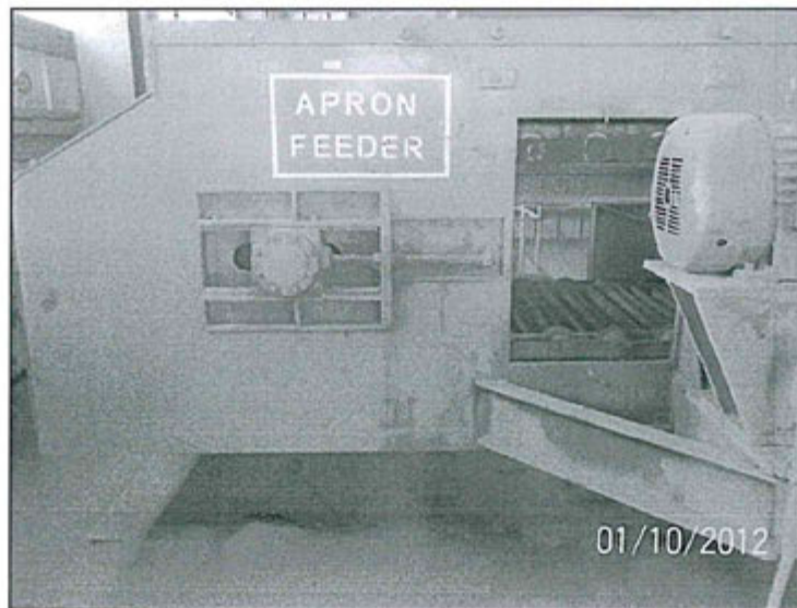
Hallazgo N° 25: Fotografía N° 14: Emisiones fugitivas de partículas en el apron feeder de la tolva de concentrados de zinc del tostador Lurgi.
