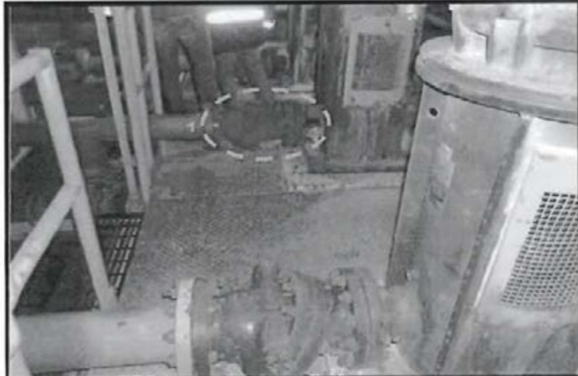
Fotografía N° 10 del Informe de Supervisión.- Sistema de válvulas de las cuales la N° 1 presentó la falla de la Válvula Chek.
