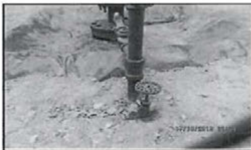
Fotografía N° 49: Pozo PB278, tipo gas lift, presenta líquido en válvula fuera de la geomembrana (490813E, 959632N)
