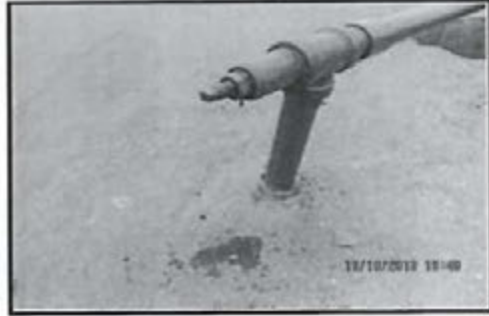
Fotografía N° 44: Pozo 6896, líquido fuera de la cantina (488530E, 9539377N)
