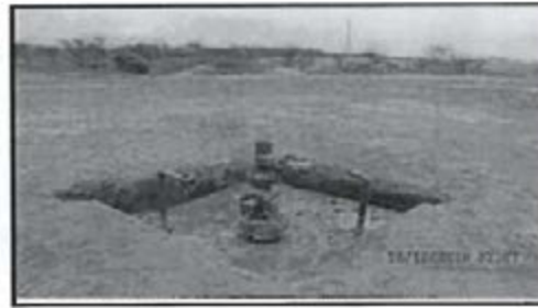
Fotografía N° 46: Pozo 7259, pozo swab presenta fuga de gas (488834E, 9540276N)
