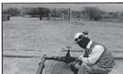
Fotografía N° 40: Pozo 1314, 6po gas (g), presenta coqueles humedecidos y válvula a 10 metros tiene líquido y tierra contaminada (491122E, 9535280N)
