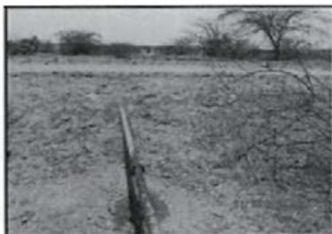
Fotografía N° 38: Líquido en línea de gas (40cm x 40 cm) (491001E, 9536674N)
