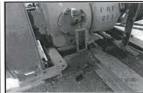
Fotografía N° 34: Pozo 6932, se observa líquido en varios puntos de la unidad de bombeo (490056E, 9540404N)
