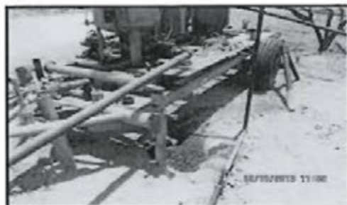
Fotografía N° 41: Manifold de campo de la batería 220 presenta manchas de hidrocarburos en el suelo cerca del roll up (400916E, 9536564N)
