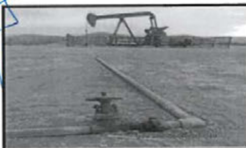
Fotografía N° 28: Pozo 5979, válvula presenta líquido (488546E, 9538452N)
