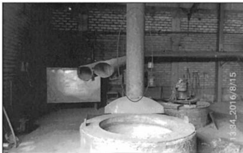
Imagen N° 02: Al interior del área de los procesos de fundición y refinación, se observó un dispositivo (chimenea) conectado al crisol de refinación. El cual es utilizado por el administrado para la liberación de los gases de
