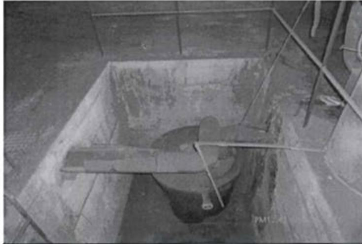
Imagen N° 03: Sistema de tratamiento de ácidos al interior del almacén de materia prima, el cual tendría la finalidad de neutralizar dichos ácidos mediante dosificación de soda cáustica, antes de ser descargado a la red de alcantarillado.
