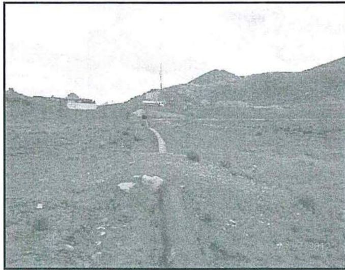
Fotografía N° 11 del Informe de Supervisión.- Tubería de conducción de relaves que sale de la planta concentradora Amistad y pasa por un costado de la ex laguna Morococha (relavera remediada) sobre el suelo.
