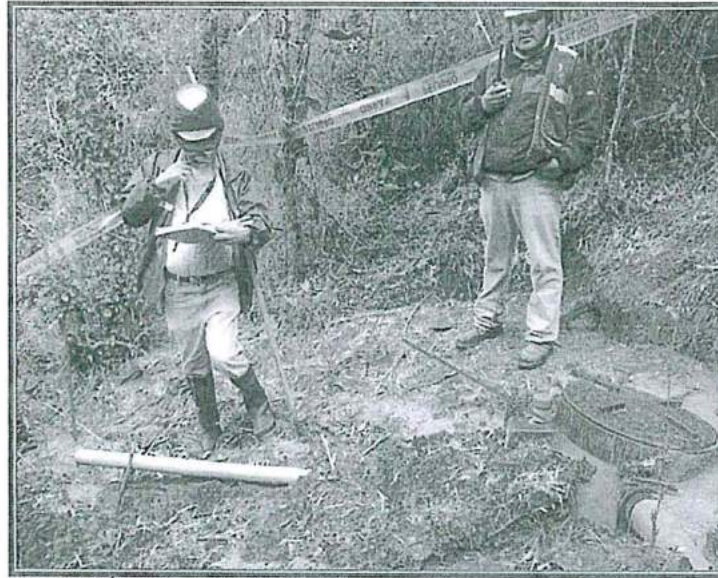
FOTOGRAFÍA N° 77.- Instalaciones del biodigestor del campamento de Cañariaco Sur, no cuenta con poza de percolación emitiendo directamente al ambiente.
