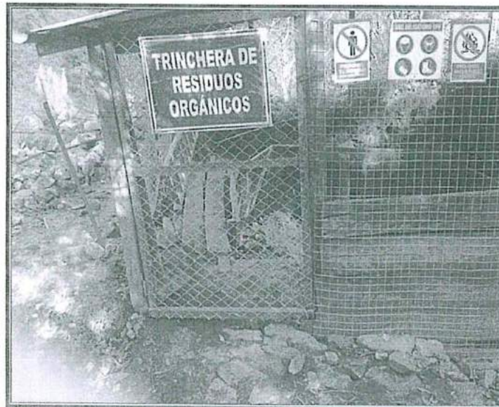
FOTOGRAFÍA N° 74.- Trinchera de disposición final de residuos orgánicos no cuenta con sistema de captación de lixiviados.
