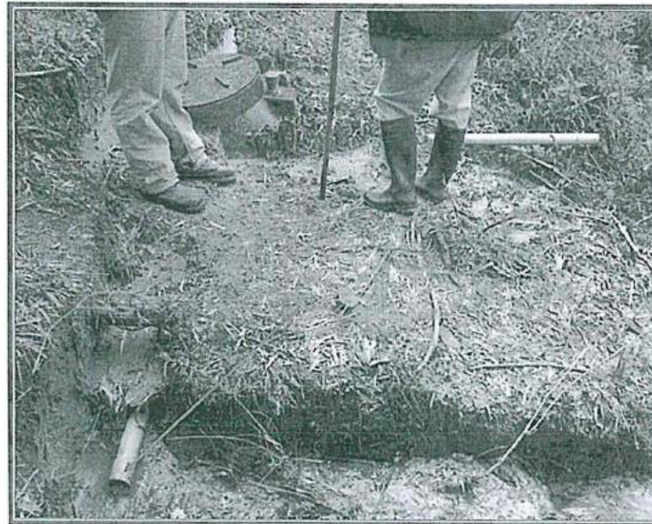
FOTOGRAFÍA N° 78.- Instalaciones del biodigestor del campamento de Cañariaco Sur no cuenta con poza de percolación emitiendo directamente al ambiente.
