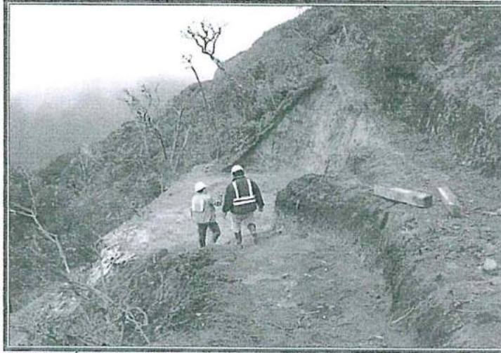
FOTOGRAFÍA N° 40.- Sector Cañariaco Norte. Plataforma DH13-30 emplazada en las coordenadas 691 094 E – 9 325 604 N; en la Información entregada figura como DH12-30, se ejecutó entre el 26 de marzo al 08 de abril de 2013 con 252.5 m perforados.
