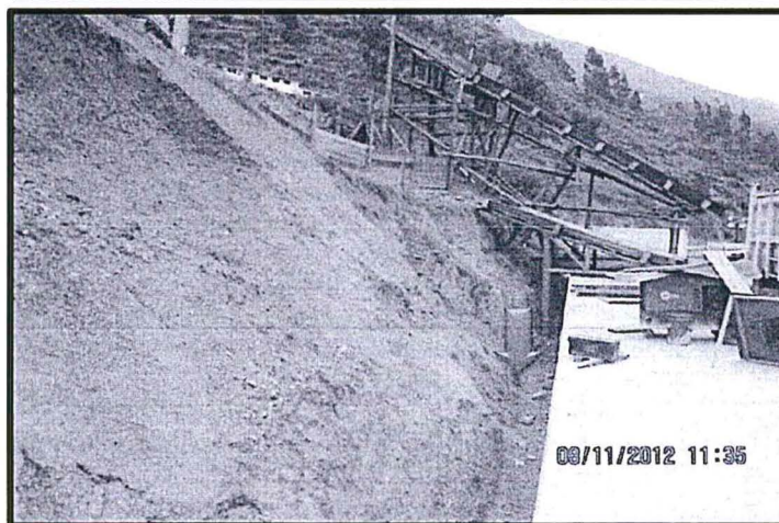
Vista N° 14. Trabajos que está efectuando el Administrado para la estabilización del talud del cerro Pucruhacra. También se observa que el acueducto de conducción no está enterrado al ras del piso.
