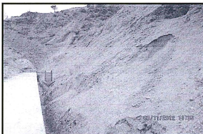
Vista N° 13. Vista de un sector donde se ha efectuado un canal al lado del acueducto de conducción, no estando enterrado al ras de piso, como requiere el EIA.
