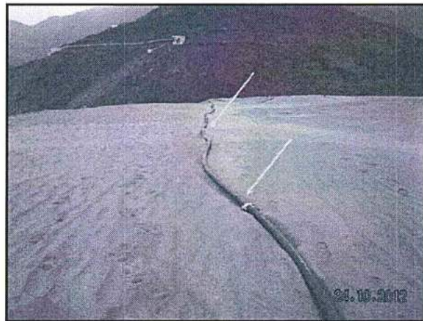
Fotografía N° 84 del Informe de Supervisión: La tubería de riego está instalada pero no cuenta con algunos dispositivos para hacer uso del mismo como los aspersores o rociadores, que en este tramo no están instalados.
