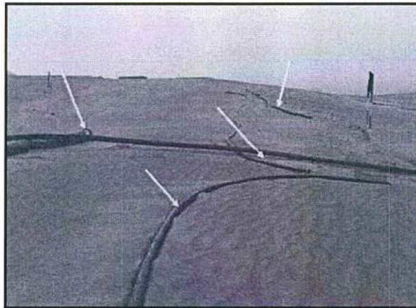
Fotografía N° 83 del Informe de Supervisión: En el Depósito de Relaves 1 y 3 se constató el levantamiento de polvos por acción de los vientos. Existe una tubería para el riego de los depósitos, sin embargo, en algunos tramos está se encuentra desinstalada.
