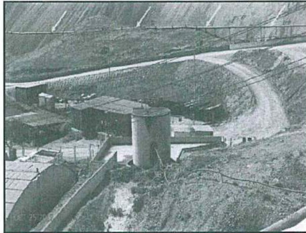
Fotografía N° 16 del Informe de Supervisión: Vista de parte de las tuberías que transportan relaves hacia el Depósito de Relaves.
