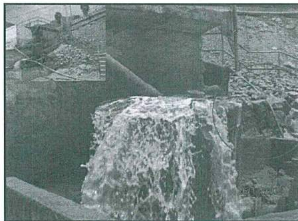
Fotografía N° 165 del Informe de Supervisión: Se evidencia que parte de las aguas recuperadas salpican fuera de la poza de distribución de estas al canal colector que descarga a la poza WAZ.
