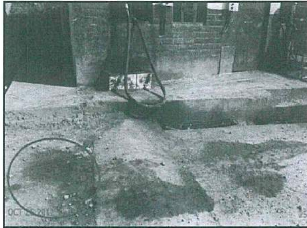
Fotografía N° 124 del Informe de Supervisión: Se observan suelos impregnados con hidrocarburos fuera de la losa de concreto del surtidor.
