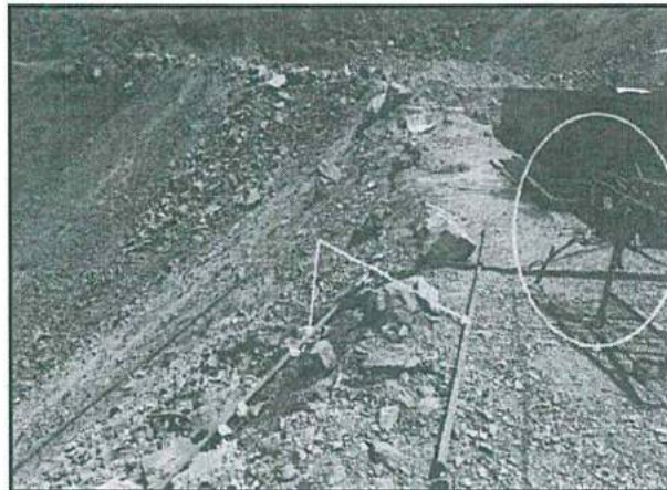
Fotografía N° 137 del Informe de Supervisión: En el Nivel +295 de Mina Condestable. Zona posterior de la losa de concreto. Se observan estructuras metálicas.
