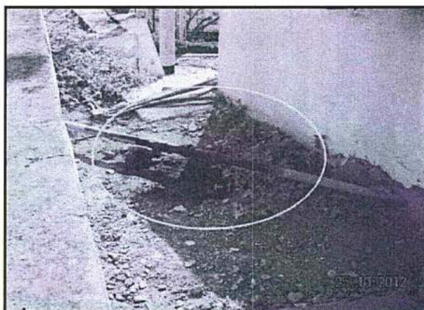
Fotografía N° 130 del Informe de Supervisión: Las tuberías del sistema del tanque de combustibles presentan fugas que permiten que el combustible caiga al suelo.
