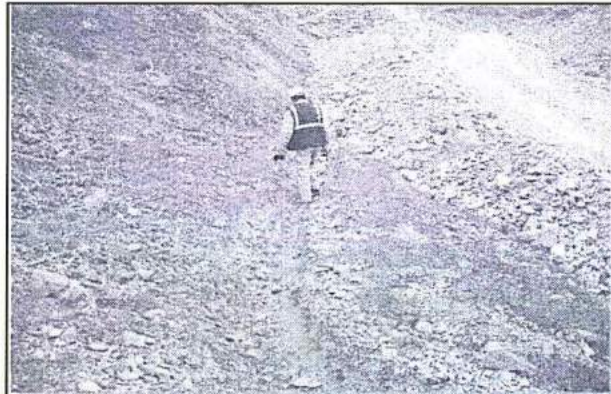
Foto 08: Canal de coronación del depósito de desmote Raúl, obstruido en un tramo de 90 metros (entre las coordenadas UTM (WGS-84) 327295 E , 8594302 N y 327364 E , 8594365 N).
