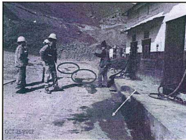
Fotografía N° 123 del Informe de Supervisión: Vista de la losa de concreto impregnada de hidrocarburos por derrames. También se observan suelos impregnados de hidrocarburos.
