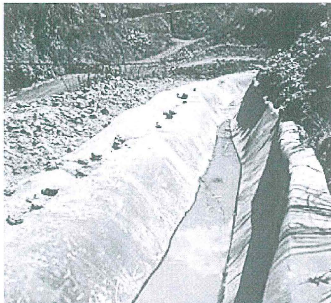
Fotografía N° 7: Canal de geomembrana en la relavera 10.
