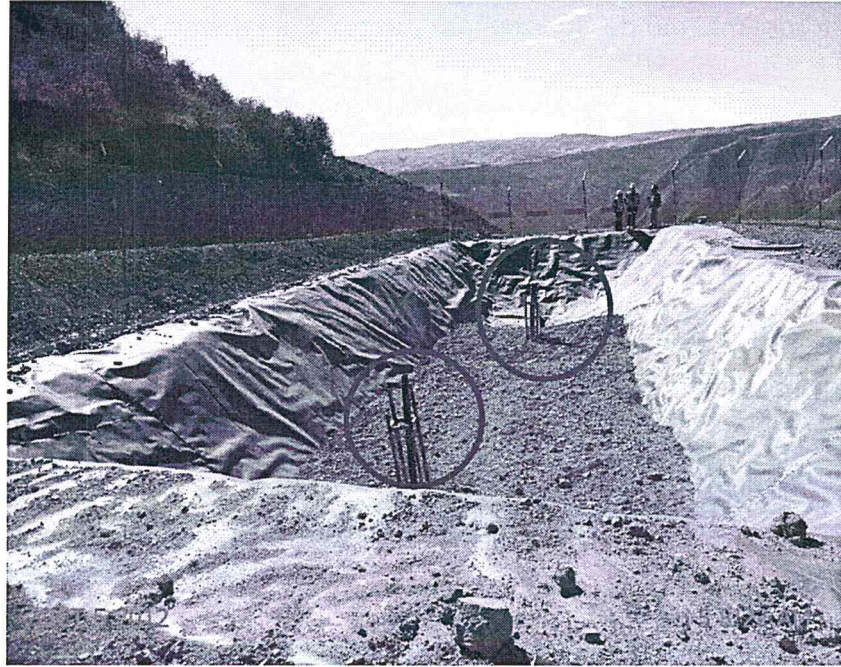
Fotografía N° 86: Supervisión regular 2012. Observación N° 11. El relleno sanitario reubicado de acuerdo a la recomendación 2011, no cuenta con canales perimétricos para la captación de aguas de escorrentía (Líneas punteadas). Se observan las chimeneas para la liberación de los gases (Círculo rojo).
