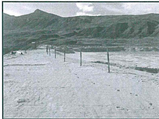
Fotografía N° 59 del Informe de Supervisión: Observación N° 13, Supervisión 2012: Se observa la Relavera N° 3, la cual no cuenta con un sistema para mitigar el polvo.
