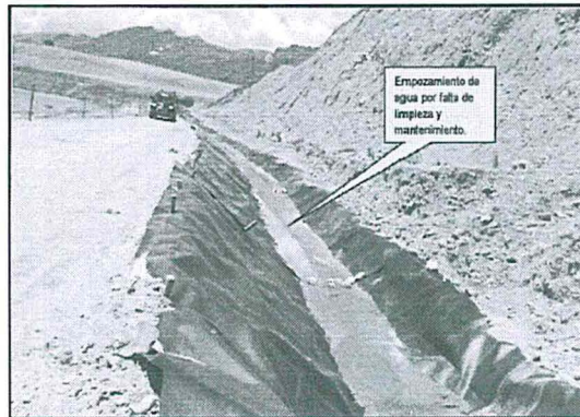
Fotografía N° 56 del Informe de Supervisión: Observación N° 12, Supervisión 2012: Se observan residuos de material por falta de mantenimiento en el canal de coronación.
