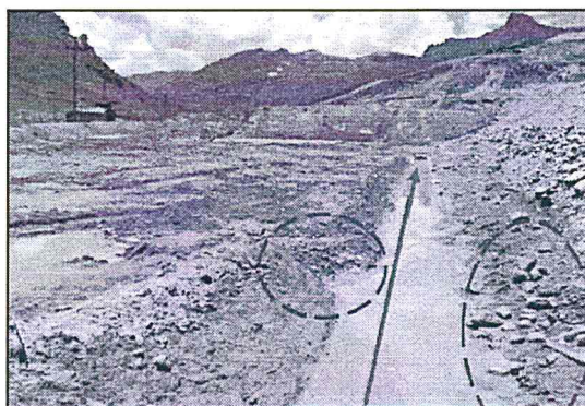
Fotografía N° 29 del Informe de Supervisión: Observación N° 12, Supervisión 2012: Se observan residuos de material por falta de mantenimiento en el canal de coronación o escorrentía.
