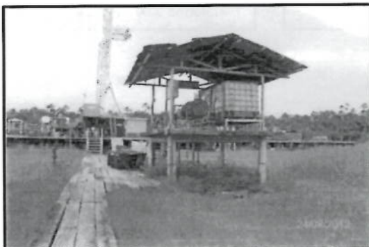
Fotografía N° 25: Vista del Inyector de Químicos de la Plataforma 32X del Yacimiento Yanayacu. En dicho lugar, debajo de la caseta se observó suelos afectados con hidrocarburos.
