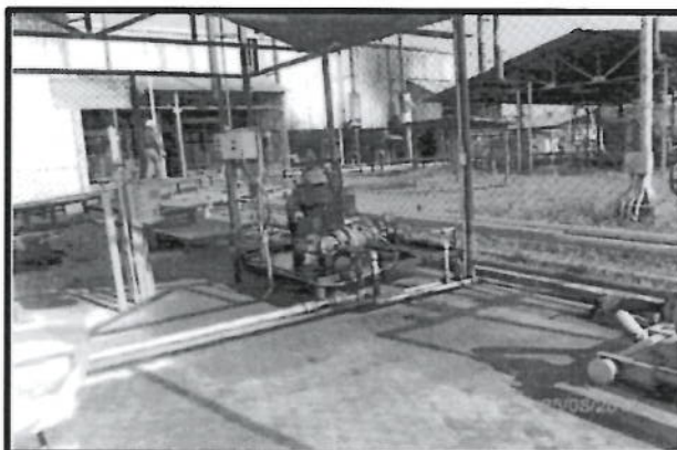
Fotografía N° 40: Vista de fuga de hidrocarburos por válvulas, uniones de la tubería de conexión de la bomba de abastecimiento de combustible (coordenadas UTM, Sistema WGS 84: 0505475E, 9460963) ubicado en la Batería del Yacimiento de Yanavacu.
