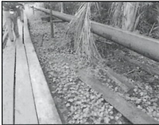
Fotografía N° 12: Vista de suelos afectados con hidrocarburos ubicados en el derecho de vía de ductos entre la plataforma 60X y la Plataforma 32X del Yacimiento de Yanayacu.
