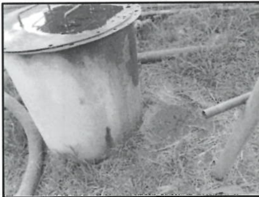
Fotografía N° 38: Vista de suelos afectados con hidrocarburos por fuga de petróleo en uniones, tuberías y tanques (coordenadas UTM, Sistema WGS 84: 0505464E, 9460985N; 0505463E, 9460989N) en el Yacimiento de Yanayacu
