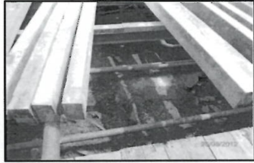
Fotografía N° 53: Vista de suelos afectados con hidrocarburos y productos químicos en la siguiente coordenada UTM, sistema WGS 84: 0464196E; 9562289N de la Plataforma 123.
