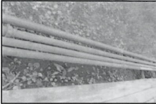
Fotografía N° 10: Vista de suelos afectados con hidrocarburos ubicados en el derecho de vía de ductos entre la plataforma 60X y la Plataforma 32X del Yacimiento de Yanayacu.
