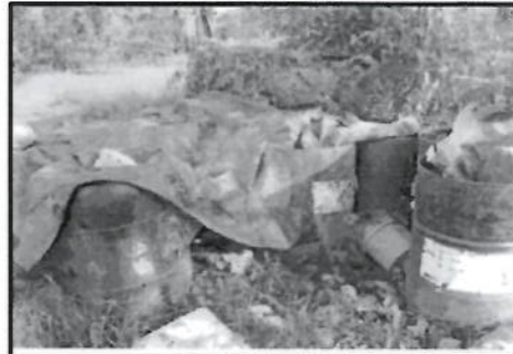
Fotografía N° 36: Vista de suelos afectados con hidrocarburos por fuga de petróleo en uniones y tuberías (coordenadas UTM, sistema WGS 84: 0505464E, 9460985N y 0505463E, 9460989N)
