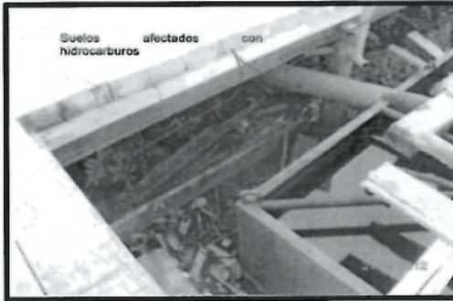
Fotografía N° 22: Vista de suelos afectados con hidrocarburos ubicados debajo de la Plataforma 32X del Yacimiento Yanayacu.
