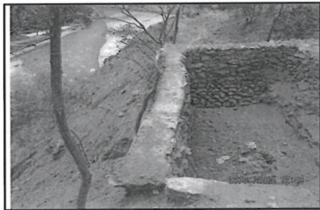
Fotografía N° 7 Descripción: Parte del relleno sanitario en nivel superior de la ribera del río Chamaya.
