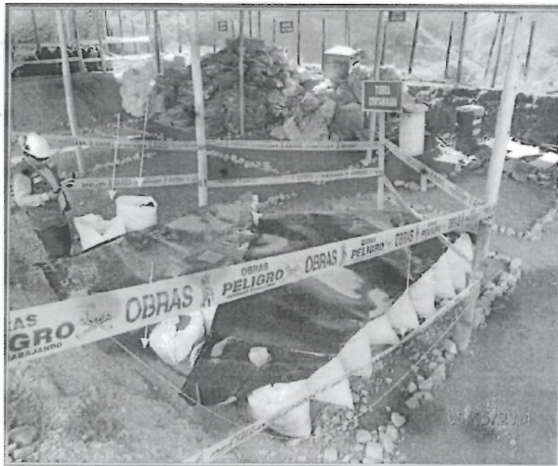
Fotografía N° 32: Hallazgo N°1. Se observa la falla de revestimiento e impermeabilización de la celda donde se ubica el material contaminado con Hidrocarburo ubicado en las coordenadas (Datum WGS 84) N9158481, E806857
