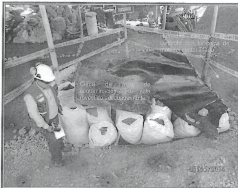
Fotografía N° 31: Hallazgo N° 1. Se observa la celda de material contaminado sin una adecuada impermeabilización. En las coordenadas (Datum WGS 84) N9158481, E806857
