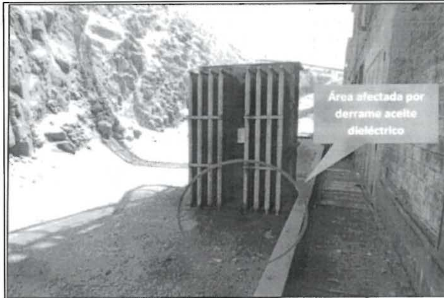
Fotografía N° 2: Vista del área afectada por el derrame de aceite dieléctrico del transformador
