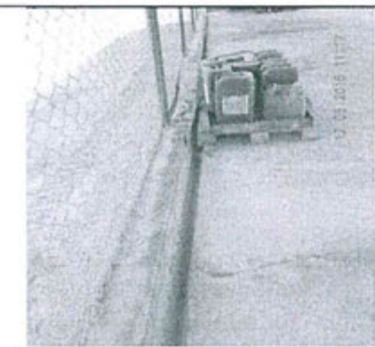
Fotografía N° 4: Vista del sistema de drenaje ante posibles derrames (poza de contención y canaleta de descarga)
