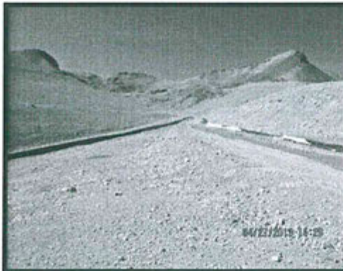
Foto N° 17: Acceso a los componentes falta completar el cierre.
