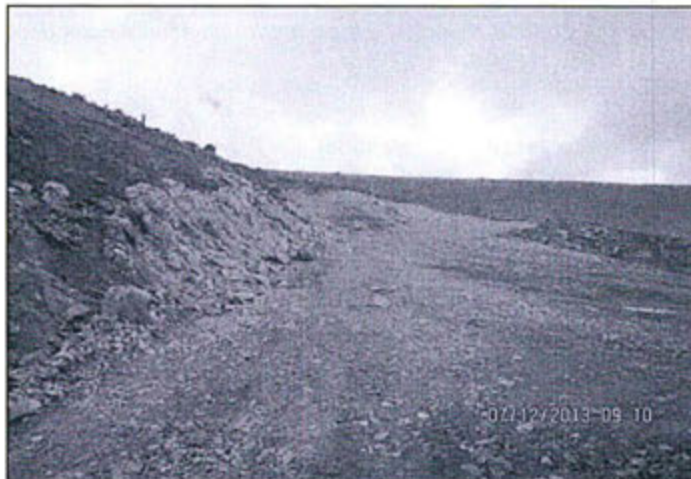
Fotografía N° 86: Depósito de desmontes no contemplado en el EIA de la U. M. El Diablo, sin canal de coronación.
