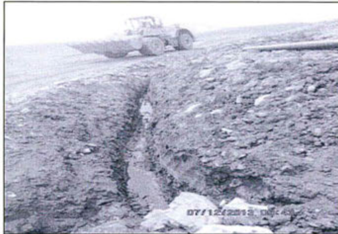
Fotografía N° 108: Efluente de la tubería de subdrenajes captados en el canal de escorrentía al pie del depósito de desmontes, con un caudal aproximado de 15 ml/s.
