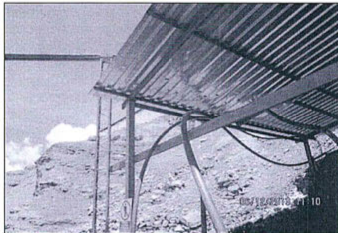
Fotografía N° 71: Tubería de conducción de relaves, desde la planta hasta el depósito, sin sistema de contingencias.
