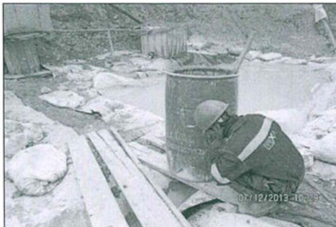
Fotografía N° 31: cilindro para dosificación de floculante en las pozas de descarga y tratamiento de aguas de mina de la bocamina vetas El Diablo (El Santo)
