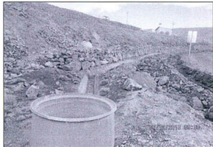
Fotografía N° 104: Canal de captación de drenajes del depósito de desmontes contemplado en el EIA de la U. M. El Diablo
