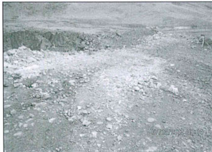
Fotografía N° 91: Depósito de desmontes no contemplado en el EIA de la U. M. El Diablo sin canal de coronación.
