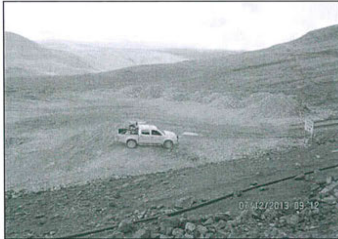
Fotografía N° 89: Depósito de desmontes no contemplado en el EIA de la U. M. El Diablo sin canal de coronación.
