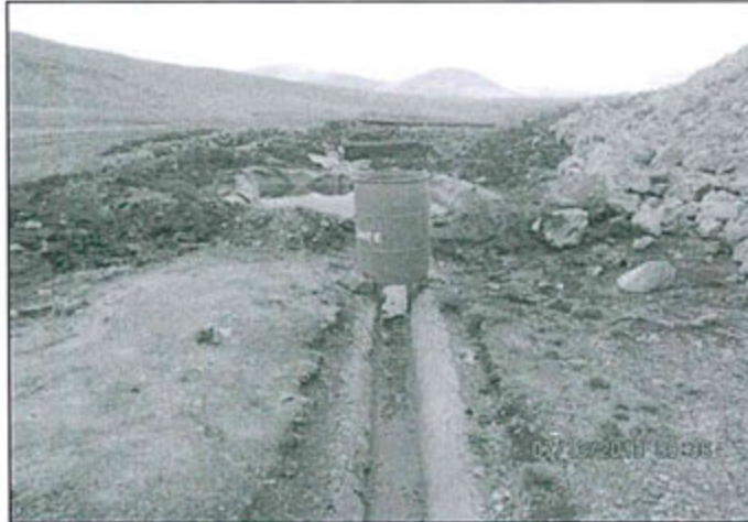
Fotografía N° 105: Cilindro de dosificación de floculante al canal de captación de drenajes del depósito de desmontes.
