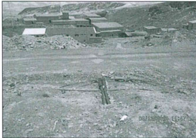
Fotografía N° 74: Tubería de conducción de relaves.
