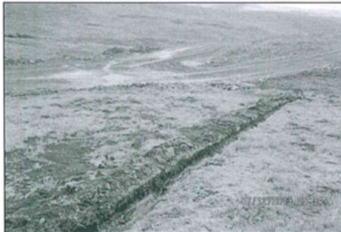
Fotografía N° 101: Canal de coronación del depósito de desmontes contemplado en el EIA Suyckutambo.
