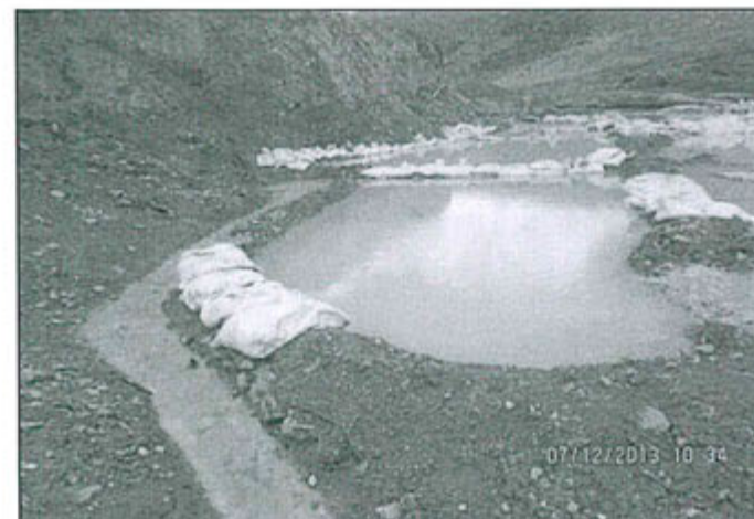
Fotografía N° 37: Pozas de sedimentación de las aguas de mina tratadas de la bocamina Vetas El Diablo (El Santo) nivel 0.
