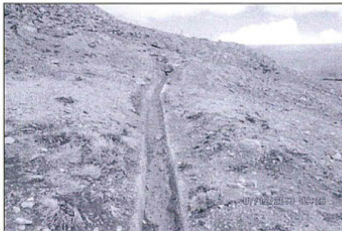
Fotografía N° 98: Canal de coronación del depósito de desmontes contemplado en el EIA Suyckutambo.
