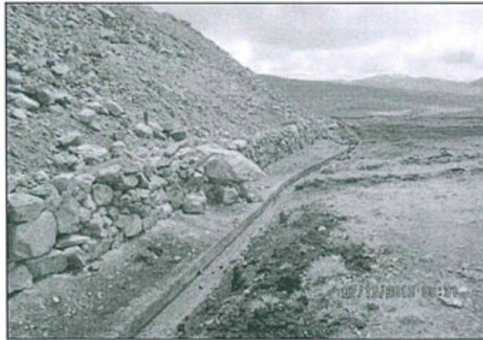
Fotografía N° 100: Canal de coronación del depósito de desmontes contemplado en el EIA Suyckutambo.
