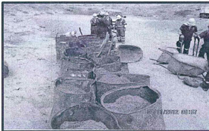
Fotografía N° 8: Punto de recuperación de tierra con crudo – noviembre 2012.
