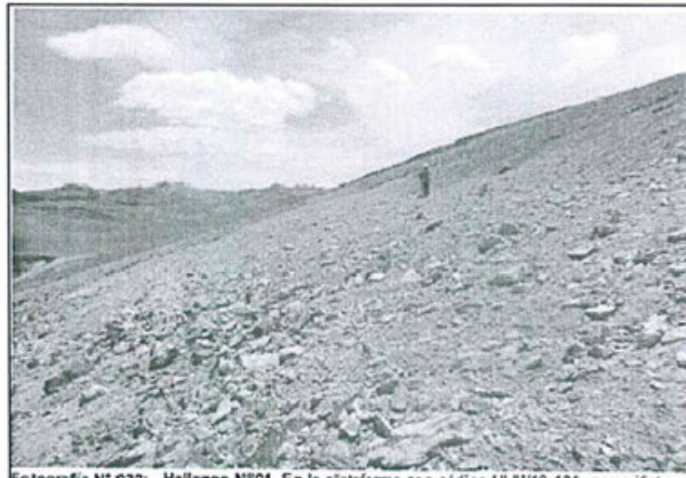
Fotografía N° 032: Hallazgo N°01, En la plataforma con código HUW10-10A, se verificó un área con presencia de rocas sueltas procedente del material de corte que son vertidas a la ladera.
