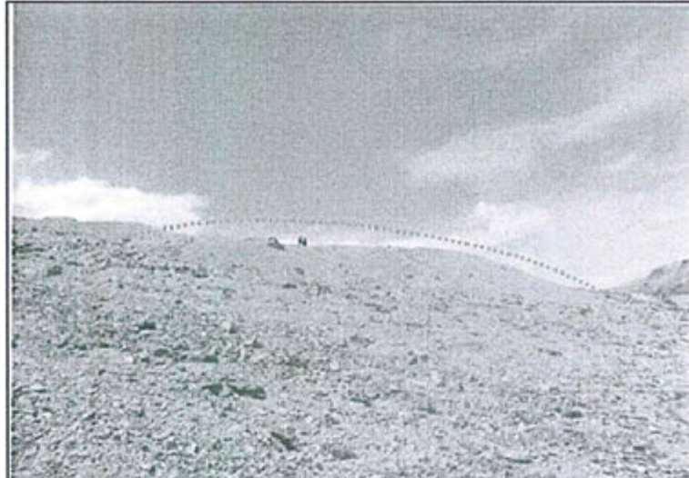
Fotografía N° 024: Hallazgo N°01, En la plataforma con código HUW10-10A, nótese rocas sueltas por toda la ladera, careciendo de una estabilización y perfilado de la zona.
