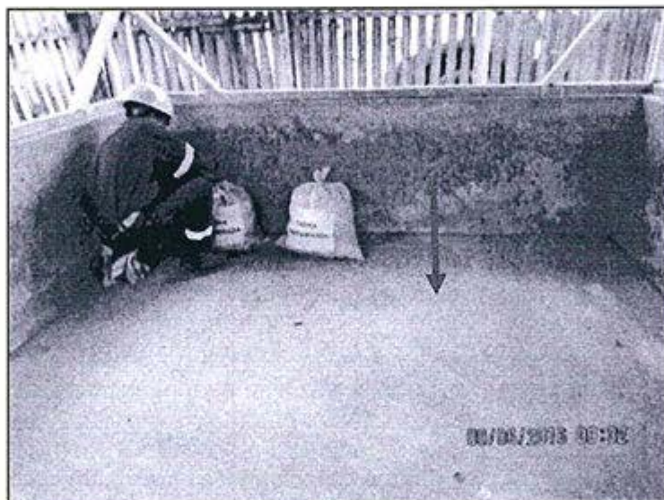
Foto 6: Almacenamiento de la tierra contaminada en el almacén de residuos peligrosos (el piso se encuentra saneado)
