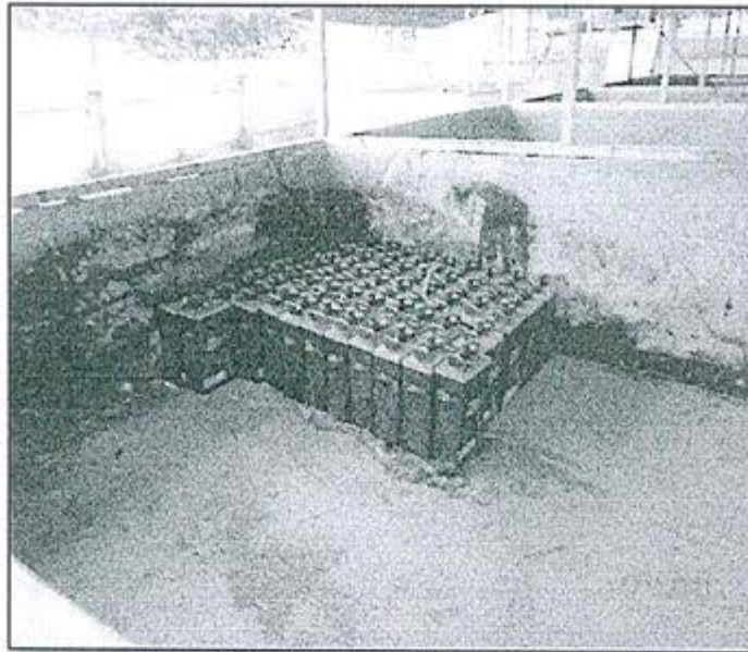
Vista 2. Detalle del piso de almacén, en donde se observa la porosidad del mismo, y por lo mismo, sin impermeabilización.
