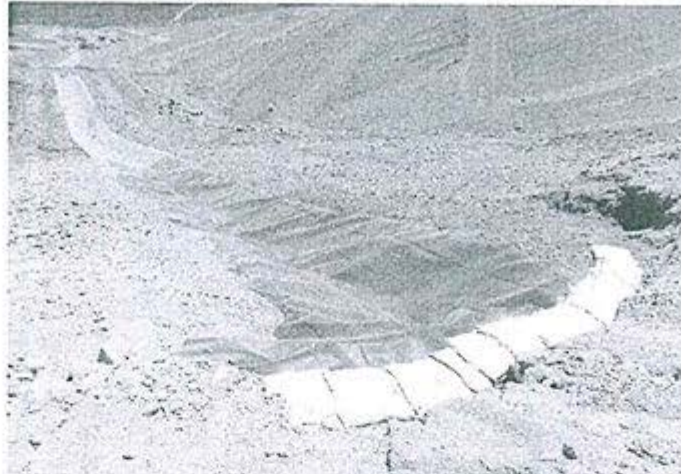
Fotografía N° 190: Hallazgo N° 1: Durante el desarrollo de la supervisión se verificó que el titular minero realizó el revestimiento mediante la colocación de geomembrana en el tramo del canal indicado en las coordenadas UTM Datum WGS 84; 8 029 192 N y 413964 E.
