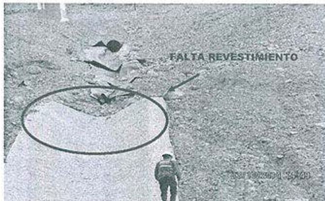
Fotografía N° 186: Hallazgo N° 1: En el canal de derivación de aguas de escorrentía del Depósito de desmontes, en las coordenadas UTM Datum WGS 8 029 192 N y 413 964 E, se evidenció que un tramo del canal se encuentra sin revestimiento.
