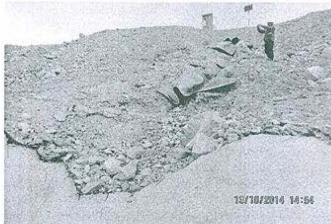
Fotografía N° 185: Hallazgo N° 1. En el canal de derivación de aguas de escorrentía del Depósito de desmontes, en las coordenadas UTM Datum WGS 8 029 192 N y 413 964 E, se evidenció que un tramo del canal se encuentra sin revestimiento.
