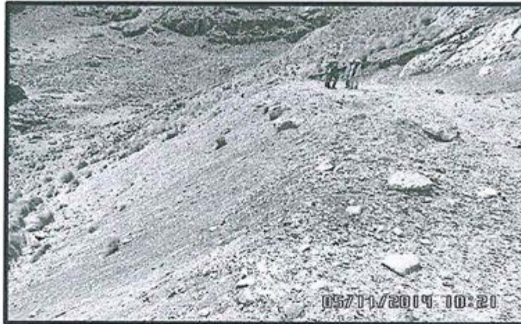
Fotografía N° 12: Vista del talud de relleno de la plataforma PL-02 de 10 m de largo por 6 m de ancho aproximadamente, construida en el Área 1. Este talud es de pendiente muy pronunciada. Ubicado en las coordenadas N 8832508, E314510 – WGS84
