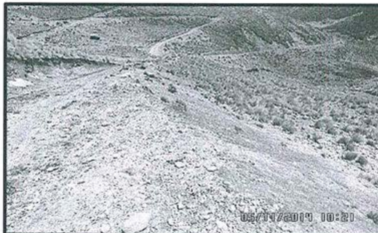
Fotografía N° 10: Vista de la vía de acceso de 4 m de ancho por 40 m de largo aproximadamente que es el acceso a la plataforma PL-02 construida en el Área 1. Ubicado en las coordenadas N8832508, E314510 – WGS84
