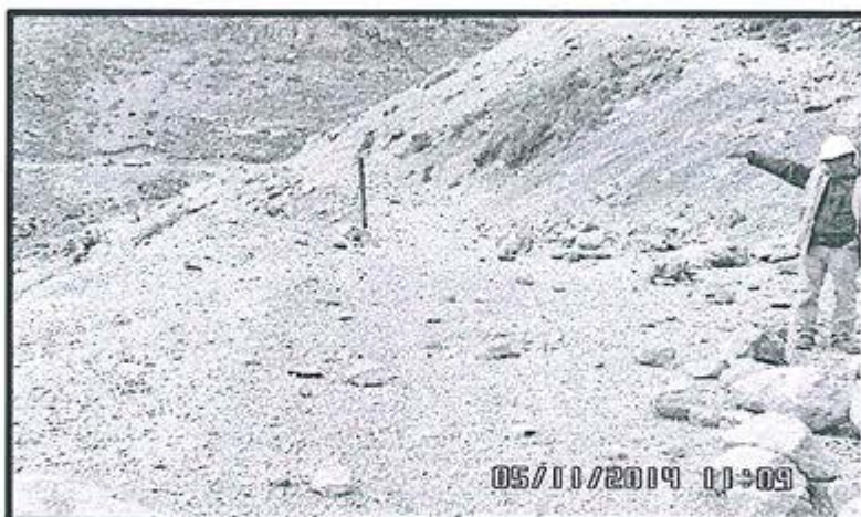
Fotografía N° 17: Otra vista panorámica de la vía de acceso ACC-04 de 3m de ancho y 100m de longitud aproximadamente. Este acceso se encuentra colapsado por derrumbe. Ubicado en las coordenadas N8833305, E313094 - WGS84
