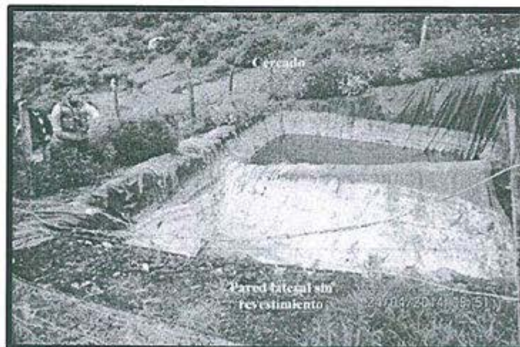
Fotografía N° 18.- Se observa el cercado perimetral de la poza de lodos de perforación.
