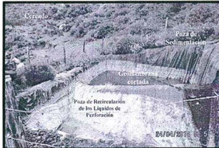
Fotografía N° 31.- Se ha constatado en la poza central de lodos de perforación, la cual se encuentra abierta y cercada, que la geomembrana en dos laterales ha sido contada desde el nivel de los lodos.
