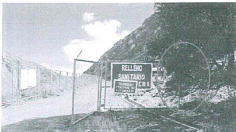
Fotografía N° 68. Observación N° 02 - 2012. Puerta de ingreso que no presenta condiciones de seguridad y protección, donde se encuentra el árbol no existe malla, siendo uno de los puntos de ingreso de animales.
