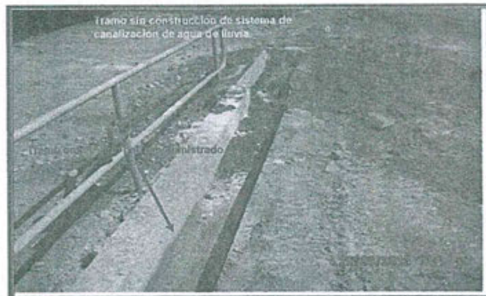
FOTOGRAFIA N° 52.- Vista de la canaleta de concreto construida en parte del frontis del área techada, el cual presenta restos de tierra en su interior, ubicado al costado de la tolva de gruesos de la planta concentradora. Incumplimiento recomendación N° 1 - 2011.
