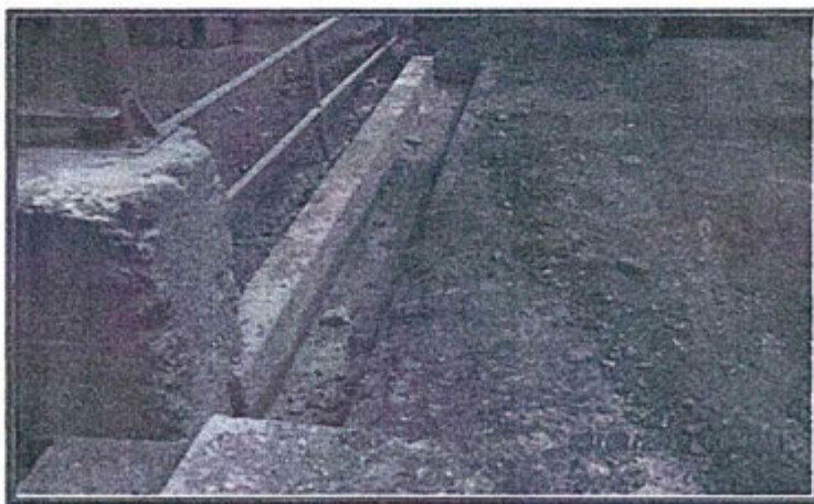
FOTOGRAFIA N° 56.- Vista del canal de concreto (que no presenta un diseño ingenieril de derivación de agua de lluvia), después de la limpieza realizada por el personal de la minera, aún se observa restos de piedras en su interior. Incumplimiento recomendación N° 1 – 2011.
