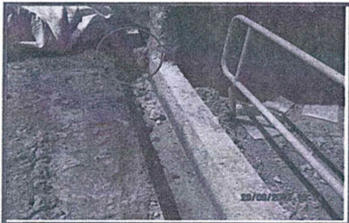
FOTOGRAFIA N° 53.- Vista del otro extremo del canal de concreto construido por el administrado, el cual no cuenta con un diseño ingenieril de derivación de agua de lluvia. Incumplimiento recomendación N° 1 – 2011.
