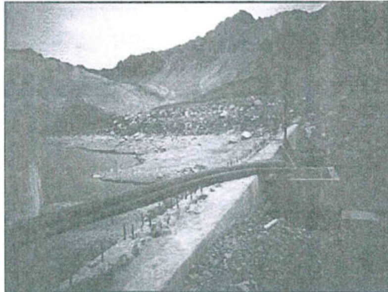
Se observa tuberías que conducen aguas de la recuperación de filtrado al cajón para ser derivadas a la Relavera N° 3.
