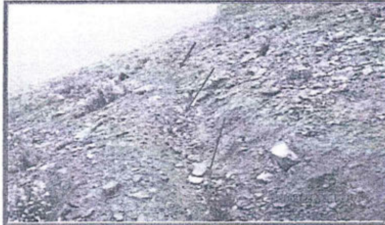
FOTOGRAFIA N° 130.- Vista del canal de coronación sobre suelo natural. Durante la supervisión se constató que la profundidad del canal de coronación es mínima (aprox. 10 cm) y presenta una conformación irregular en las paredes del canal. Incumplimiento recomendación N° 11 – 2011.
