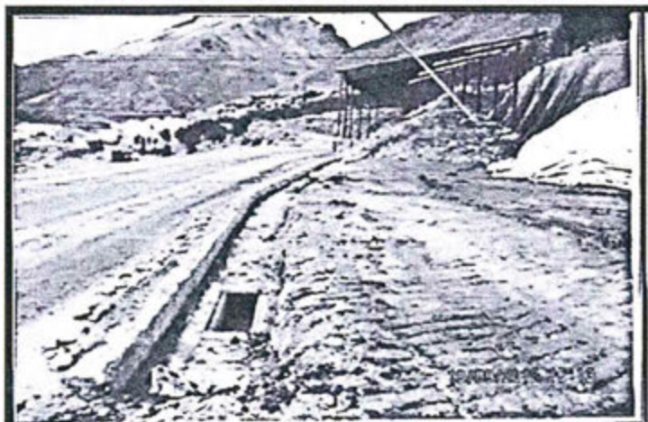
FOTOGRAFIA N° 214.- Se precisa el área donde se encuentra ubicado el stock pile (coordenadas UTM datum WGS 84: Este 0365720, Norte 8712350). Este componente no está contemplado en un instrumento de gestión ambiental que autorice su funcionamiento.
