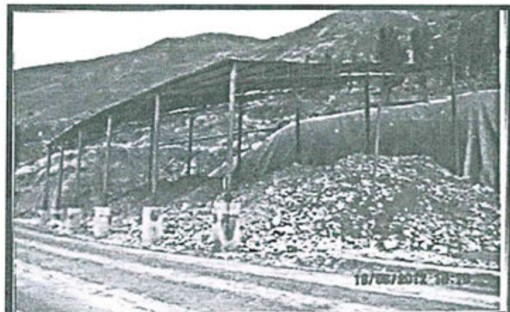
FOTOGRAFIA N° 216.- Se precisa el área donde se encuentra ubicado el stock pile (coordenadas UTM datum WGS 84: Este 0365720, Norte 8712350). Este componente no está contemplado en un instrumento de gestión ambiental que autorice su funcionamiento.
