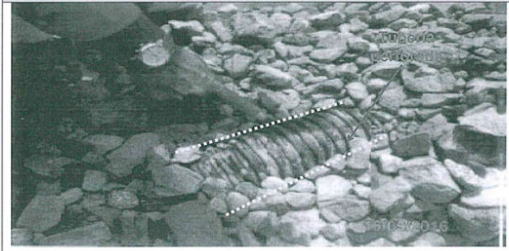
Imagen N° 8: Vista de la tubería perforada que capta los lixiviados (Coordenadas UTM WGS 84 0491284E, 8455868N Altitud de 3596m.s.n.m.)
