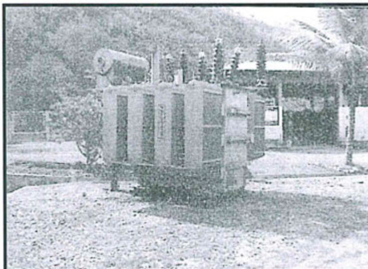
Fotografía N° 27. Transformador BEZ de 7000 kVA usado abandonado en terreno abierto y sobre suelo con cobertura vegetal, en la CH Gera I
