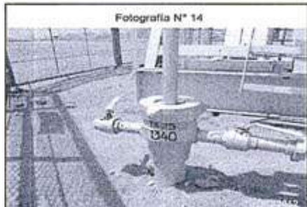
En la plataforma del pozo 1340 se observa la falta de un sistema de contención de fugas y derrames.
