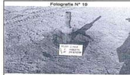
En el registro fotográfico se muestra al pozo 6341, el cual no contiene un sistema de contención, recolección, en el caso que sucediera una fuga y derrame de hidrocarburo. Asimismo, se halló suelo impregnado con hidrocarburo alrededor de la boca de pozo.
