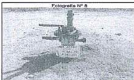
En el registro fotográfico se muestra el pozo 10302, el cual no contiene un sistema de contención, recolección, en el caso que sucediera una fuga y derrame de hidrocarburo.
