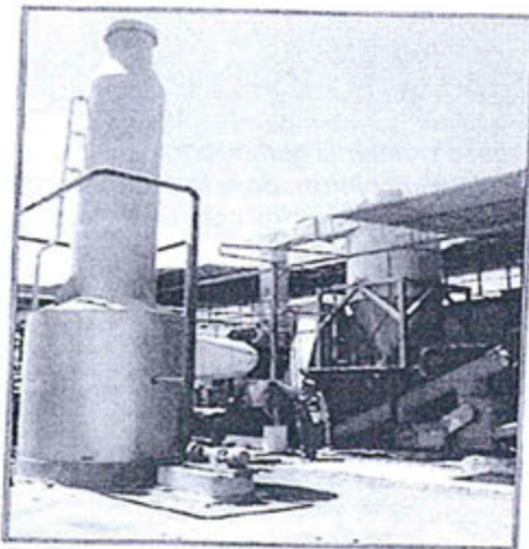
Foto 41. Torre lavadora inoperativa.
