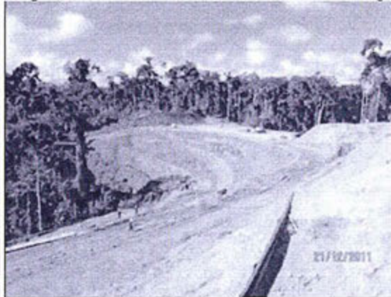
Fotografía N° 24: Inadecuado control de la erosión en la locación Sagari
