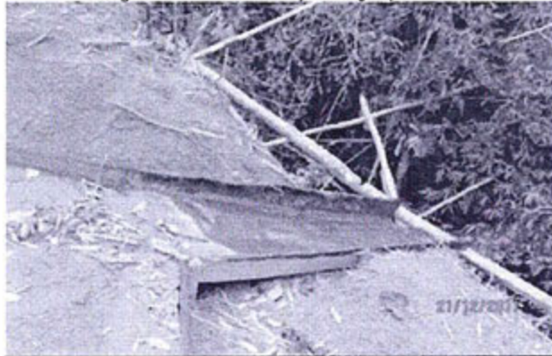
Fotografía N° 18: Inadecuado manejo de las aguas pluviales.
