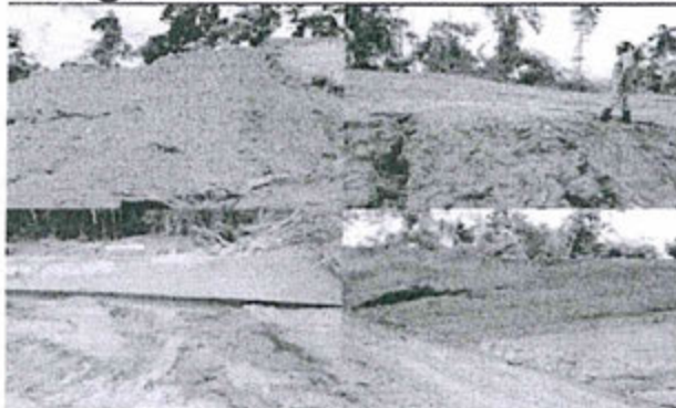
Vistas de áreas erosionadas, en la construcción de la vía del Tramo I que va de la base Kinteroni al campamento Nuevo Mundo.
