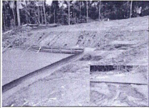
Se aprecia un área de depósito, de materiales de excedentes, en el cual se aprecia erosión de la tierra, el cual esta ocasionando acarreo de sedimentos hacia la quebrada cercanas.
