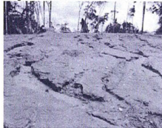
Fotografía N° 19: Inadecuado control de la erosión
