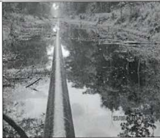
Se observa el canal de flotación muestra la presencia de petróleo crudo derramado contenido en el canal y que aún no se inicia con las labores de limpieza y recuperación.
