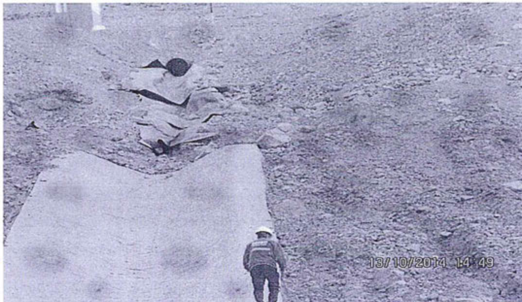
Fotografía N° 186: Hallazgo N° 1: En el canal de derivación de aguas de escorrentía del Depósito de desmontes, en las coordenadas UTM Datum WGS 8 029 192 N y 413 964 E, se evidenció que un tramo del canal se encuentra sin revestimiento.
