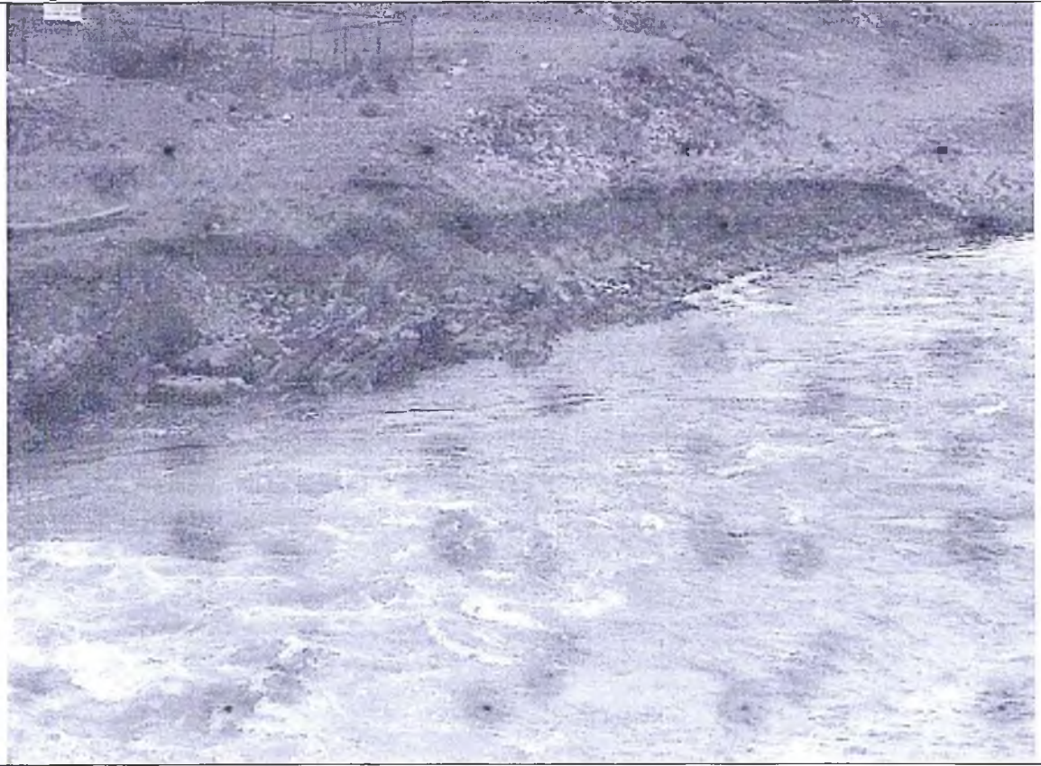
Fotografía 12. Erosión de orilla izquierda del río Mantaro aguas debajo de presa Upamayo.
