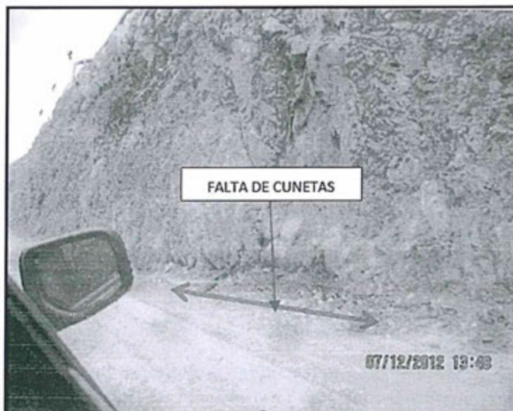
Foto N° 67: Observación N° 01-2012. En la vía de acceso a la planta concentradora, se observó que el titular minero no ha implementado cunetas para la evacuación de las aguas de escorrentía.
