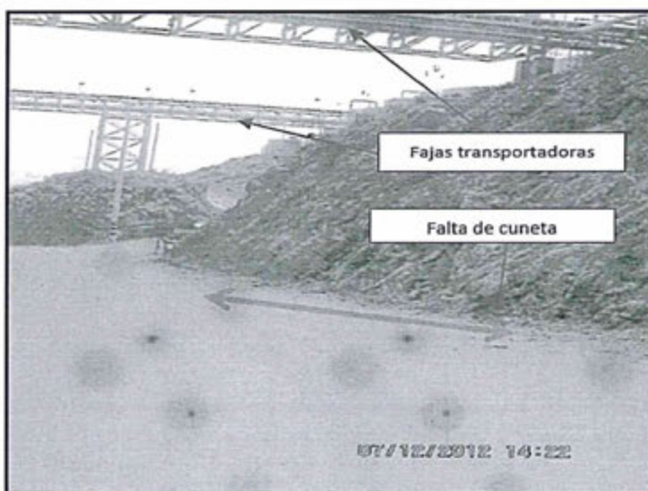
Foto N° 68: Observación N° 01-2012. Otra vista de la vía de acceso a la planta concentradora, donde el titular minero no ha implementado cunetas para la evacuación de las aguas de escorrentía.
