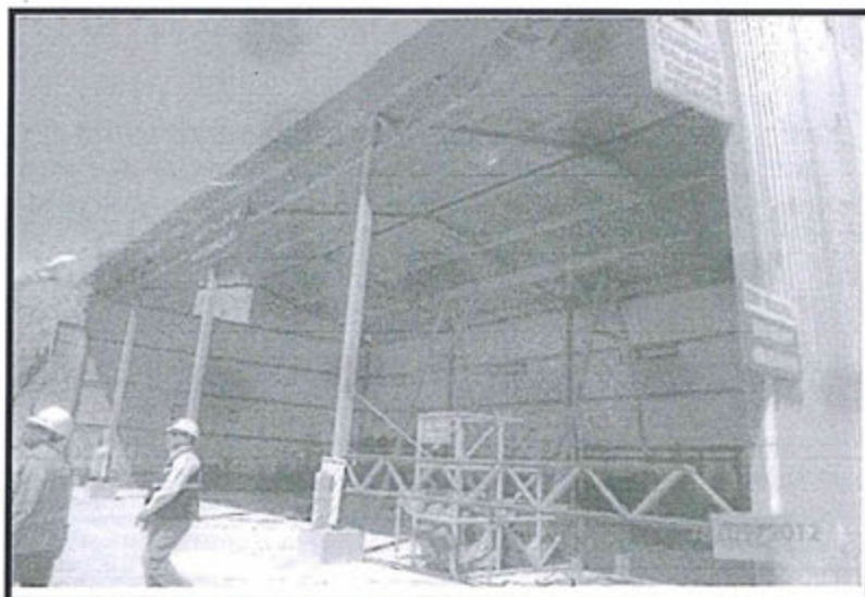
Fotografía N°4.- Vista panorámica del Taller de Mantenimiento de vehículos donde se observa que no existe muro de contención o canaleta que permita que las aguas de limpieza discurran antes de llegar al suelo.
