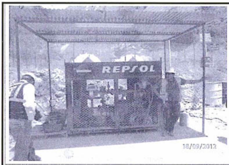
Fotografía N° 1: sistema de distribución de combustible el cual no cuenta con un dique (muro de contención).
