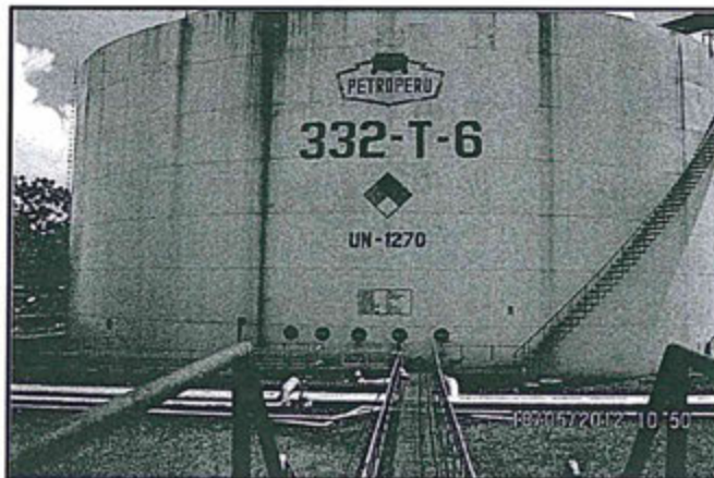
Fotografía N° 5: Vista del Tanque 332-T-6, en la cual se visualiza el área estanca con material no impermeabilizado, cubierta con vegetación.
