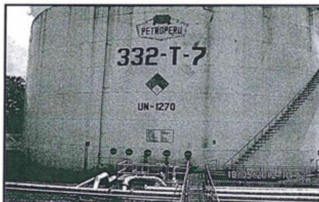
Fotografía N° 6: Vista del Tanque 332-T-7, en la cual se visualiza el área estanca con material no impermeabilizado, cubierta con vegetación.
