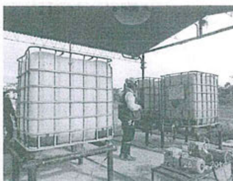
FOTO N° 132: E0404458 N3742532 / Área de Inyección de Químicas - Locación del Peto San Jacinto 27
