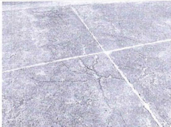
FOTO N° 265: E341737 N9690362 / Planta de reinyección de Capahuari
