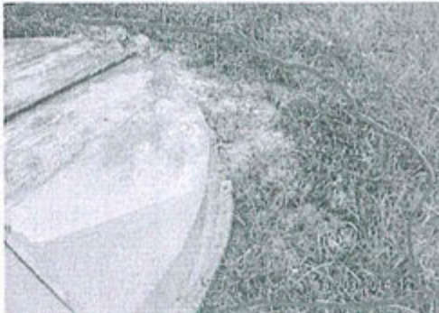
FOTO N° 255: E363010 N9712342 / Área impactada - Tanque sumidero del Pozo 5 / Yacimiento Huayuri.
