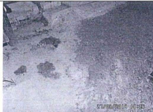
FOTO N° 251: E0403788 N9744272 / Suelo impregnado con hidrocarburos en zona cercana a Sump Tank 1421 de Batería San Jacinto
