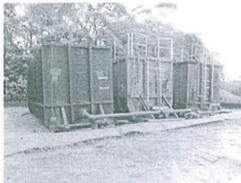
FOTO N° 84: E336748 N9701960 (PSAD 56) / Locación del pozo CN-03 - Capahuari Norte.
