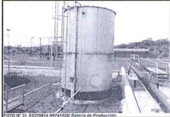
FOTO N° 31: E0370814 N9741078/ Batería de Producción
