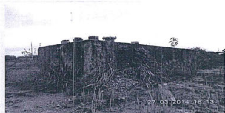
FOTO N° 290: E0403771 N9744348 / Instalación abandonada en área donde funcionó Ex Upper Pit pozos San Jacinto 18 y San Jacinto 19
