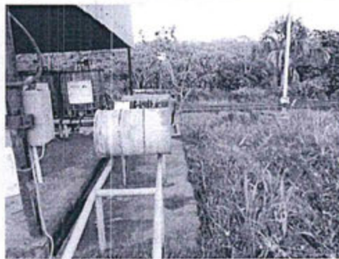
FOTO N° 98: E0373838 N9723964/ Batería de Producción.
