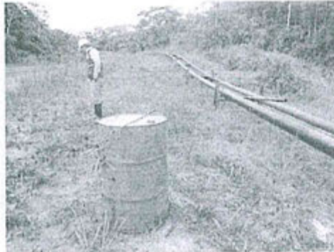
FOTO N° 107: EG374716 N9731833/ Línea de Diesel Shivyacu - Km. 12 Noroeste.
