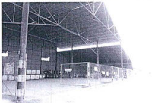
FOTO N° 118: E0375750 N9713131/ Área J del Almacén de Químicos.
