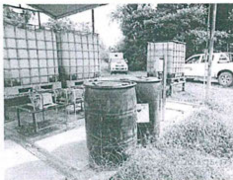
FOTO N° 133: E0405273 N3730167 / Área de Inyección de Químicas -
