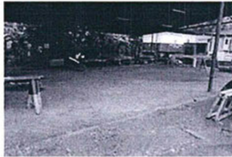
Fotografía del área de construcción, donde se puede observar que los cilindros observados fueron retirados
