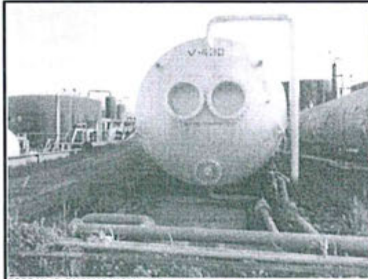
FOTO N° 47: E0173815 N9724110/ Bateria de Producción.
