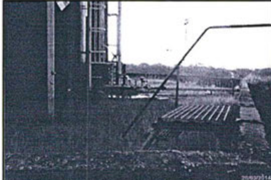
FOTO N° 18: E8373809 N9724049/ Batería de Producción.
