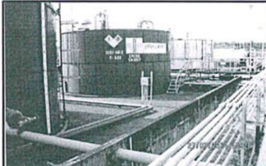
FOTO N° 37: E363529 N971211 / Tanque de almacenamiento de hidrocarburo Bateria Huayuri / Yacimiento Huayuri.
