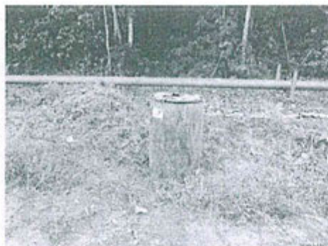
FOTO N° 104: 10374430 N0731197/ Línea de Diesel Shivyacu - Km. 12 Noreste.
