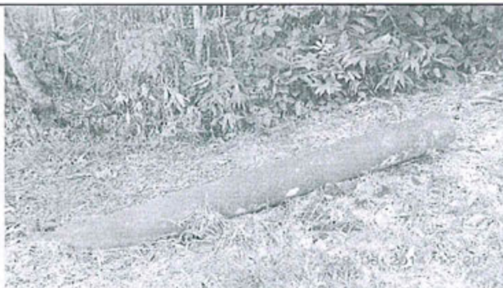
FOTO N° 291: E0393310 N9727668 / Ducto abandonado cerca a Oleoducto San Jacinto-Shiviyacu
