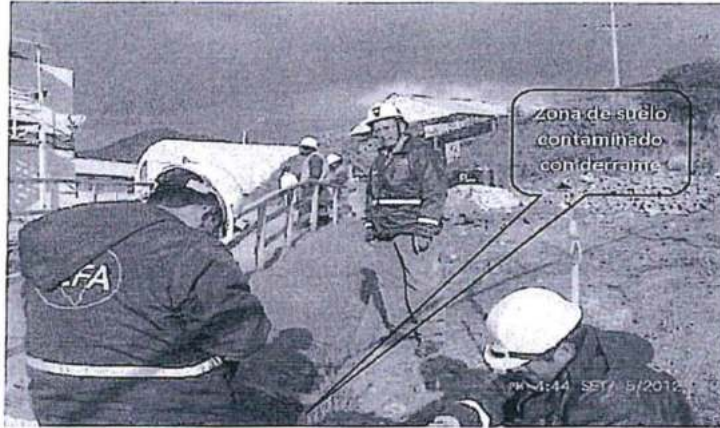
Foto N° 6: Vista de otra zona de suelo contaminado con derrame de hidrocarburo que falta ser limpiado contigua y aguas abajo de la cuneta de cemento para agua pluvial (Observación N° 1)
