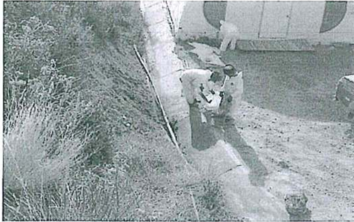
Foto N° 13: Tramo del canal pluvial de cemento en limpieza de residuos de suelo contaminados con Biodiesel durante la supervisión, ubicado en la parte inferior de la zona del derrame (Observación N° 5)
