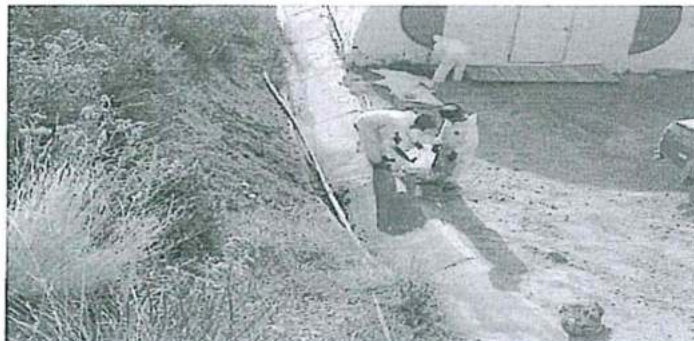
Foto N° 13: Tramo del canal pluvial de cemento en limpieza de residuos de suelo contaminados con Biodiesel durante la supervisión, ubicado en la parte inferior de la zona del derrame (Observación N° 5)
