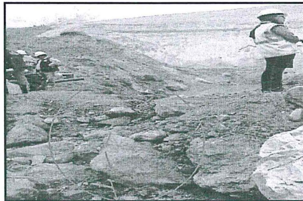
Fotografía N° 12: Zona con evidencias de huellas de rebose del agua de la zona de poza de monitoreo de subdrenaje hacia la quebrada Sayapampa. Alteración de la ribera izquierda del río Sayapampa.
