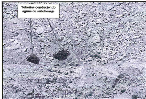
Fotografía N° 10: Vista cercana del subdrenaje que llega a la zona de captación de agua (poza de monitoreo de subdrenaje), ubicada al borde de la quebrada Sayapampa.
