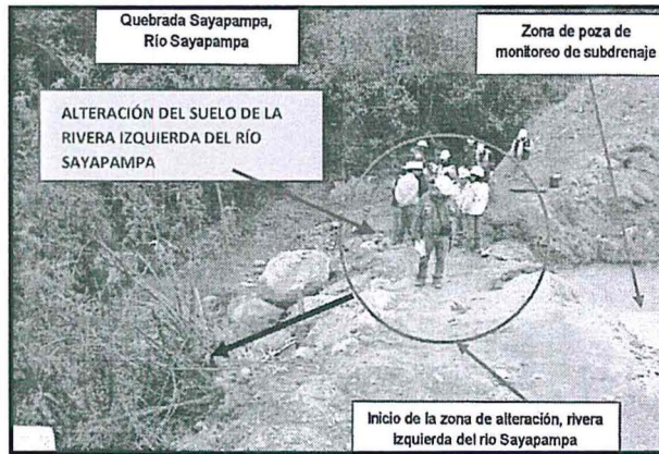
Fotografía N° 11: Zona entre la Quebrada Sayapampa y la poza de monitoreo de subdrenaje. Inicio de la zona de alteración de la ribera izquierda del río Sayapampa.
