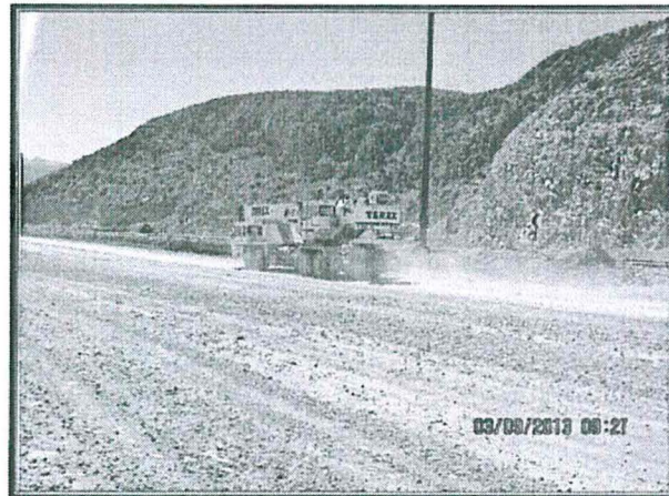
Fotografía N° 173: Hallazgo 2c Via de tránsito desde las tolvas de carguo de mineral hacia la parrilla de mineral en el área de chancado primario. Se constató la emisión de material particulado al paso de los camiones y equipos.
