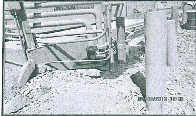
Fotografía N° 66: Hallazgo N° 5. Tanque de Aceite del Contratista Mobil. En el área del taller de mantenimiento de volquetes, en el exterior del tanque de aceite nuevo del contratista Mobil, ubicado al costado del tanque de aceite usado de 12 000 galones, existe un impacto sobre el piso de tierra producto de una fuga de aceite por la brida de la tubería.
