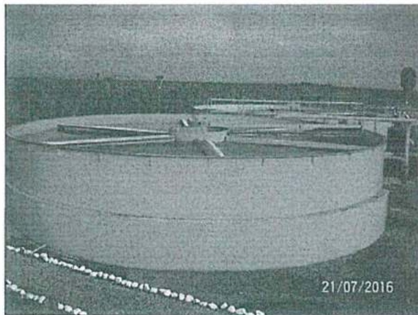
Imagen N° 02: Imagen de los clarificadores de la PTAR-I, en proceso de tratamiento de las aguas residuales industriales.
