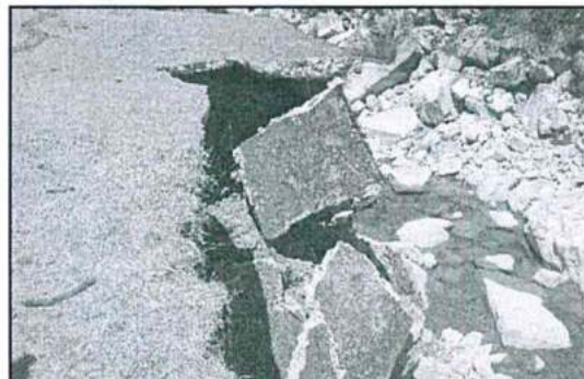
Fotografía N° 12: La losa de concreto ha colapsado y se está perdiendo cobertura vegetal.
