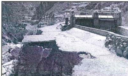
Fotografía N° 14: La desestabilización y agrietamiento ha alcanzado el muro del desarenador.
