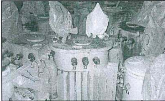
Fotografía N° 27: Transformadores usados almacenados sin espacio suficiente para su manipulación y acceso en caso de emergencia.
