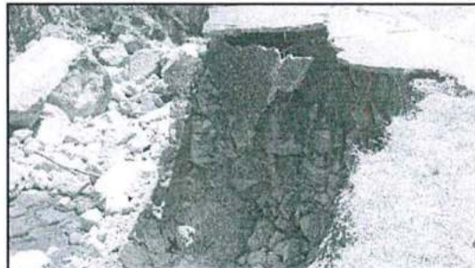
Fotografía N° 10: La erosión continúa y será violenta en el cercano periodo de avenida.
