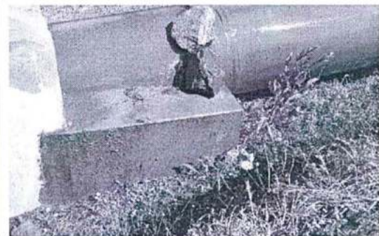
Fotografía N° 4: Fuga de agua por la junta cercana al 3° anclaje. Nótese las piedras colocadas para bajar la fuerza del chorro de agua.
