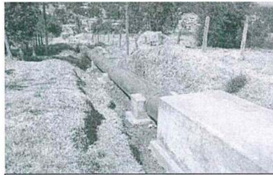
Fotografía N° 6: El suelo en el tramo superior de la tubería forzada, posterior a la cámara de carga, está erosionado por las fugas de agua de la misma.
