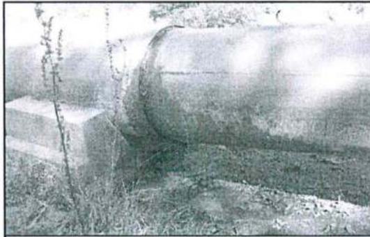
Fotografía N° 5: Fuga de agua por la junta cercana al apoyo anterior al 3° anclaje.
