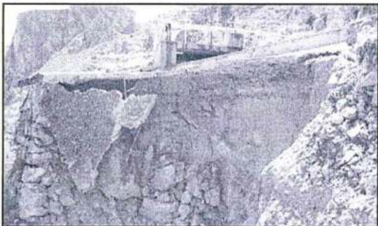
Fotografía N° 13: El avance de la erosión y derrumbe alcanzará la base de la estructura del desarenador.
