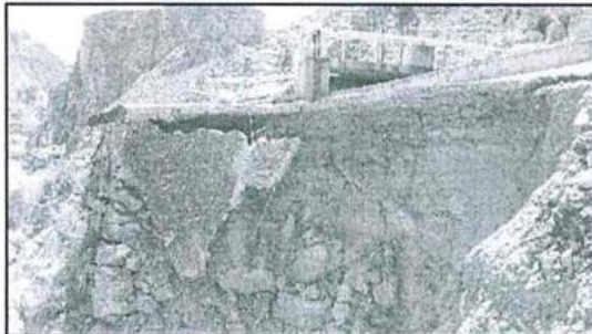
Fotografía N° 9: Fuerte erosión de la ribera derecha del río La Virgen al lado del desarenador de la CH Machu.
