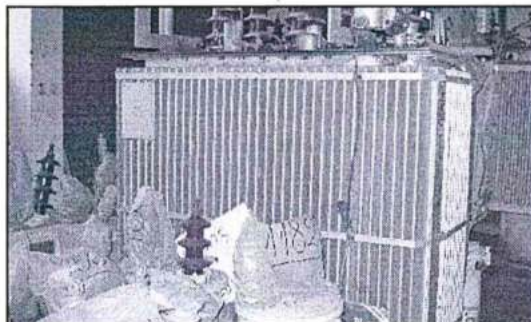
Fotografía N° 26: Transformadores usados almacenados sin conocerse su contaminación con PCB.
