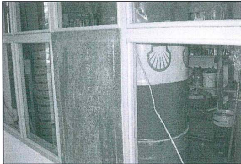
Fotografías N° 19 y 20: Tubos fluorescentes en la CH Huarisca y cilindros de aceites usados en la CH Concepción, respectivamente, almacenados inadecuadamente.
