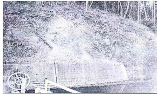
Fotografía N° 8: Pendiente erosionada con deslizamiento sobre la cámara de carga.
