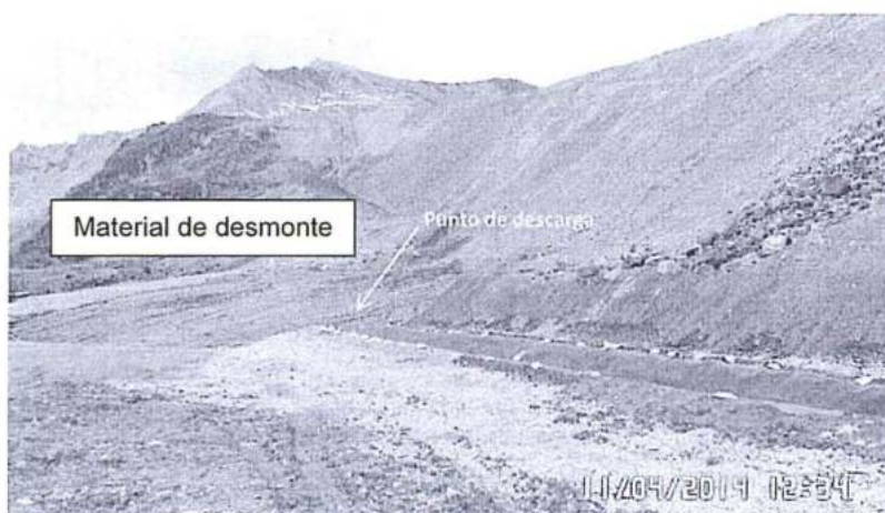
Fotografía N° 6 Vista del punto de descarga del canal revestido con geomembrana a la poza 4 B, ubicado en la parte baja del depósito de desmontes Oeste.
