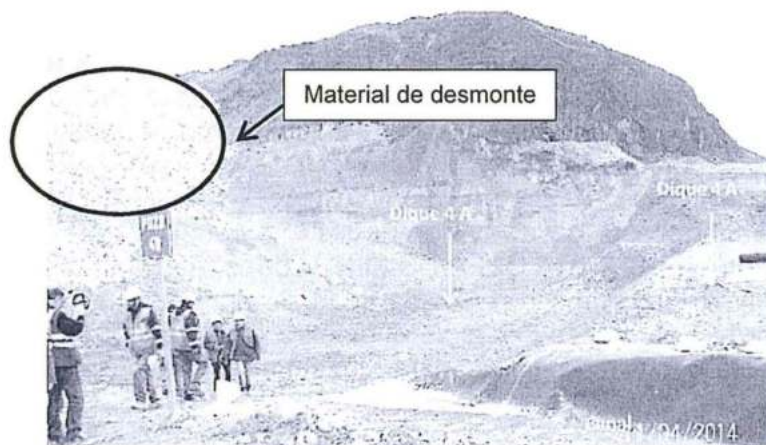
Fotografía N° 4 Vista de la poza 4 A al pie del talud del depósito de desmontes Oeste. Al lado derecho de la visa se observa el dique 4 A. En la parte baja de la vista canal revestido con geomembrana.
