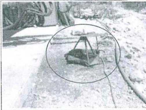
Vista 19. Vista de la zona de trabajo donde se observa la zona de trabajo y una zona afectada de 1.80 x 0.70 m aprox. afectada por aceites y grasas.
