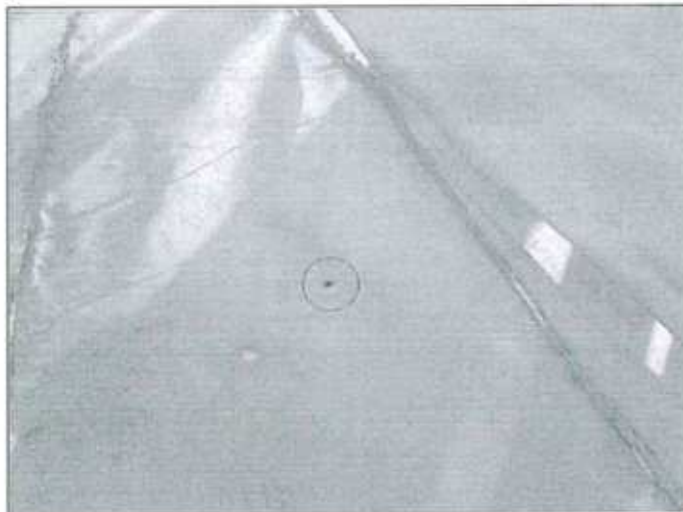
Fotografía N° 53: Revestimiento del lado oeste de la poza de contención secundaria del tanque N° 5A de almacenamiento de combustible se encuentra con agujero.
