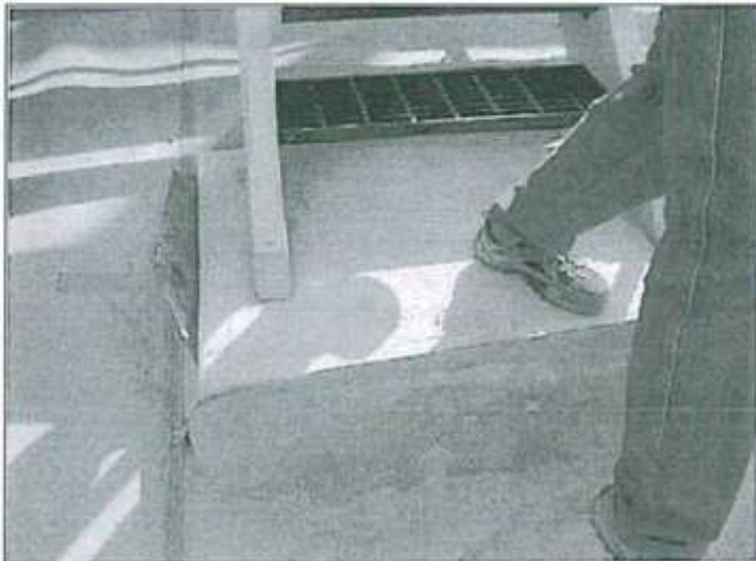
Fotografía N° 60: La geomembrana no está anclada en la parte inferior de la escalera ubicada en el lado oeste de la poza de contención secundaria del tanque N° 5A de almacenamiento de combustible.
