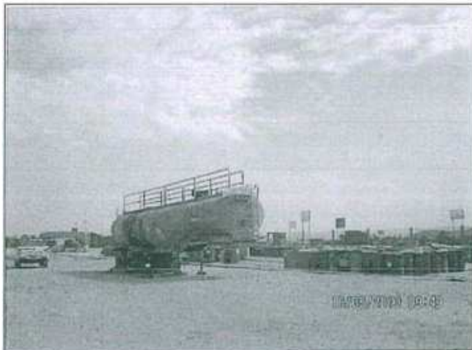
Fotografía N° 238: Cisterna donde se almacena aceites usados en el depósito de almacenamiento N° 4. El piso no se encuentra impermeabilizado.
