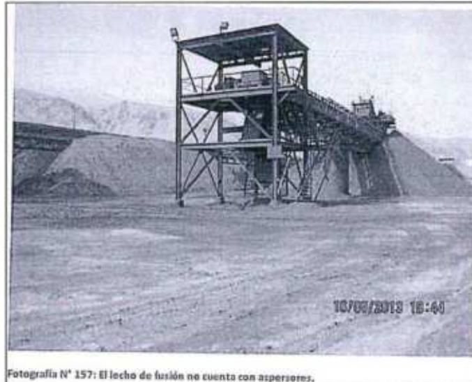
Fotografía N° 157: El lecho de fusión no cuenta con aspersores.
