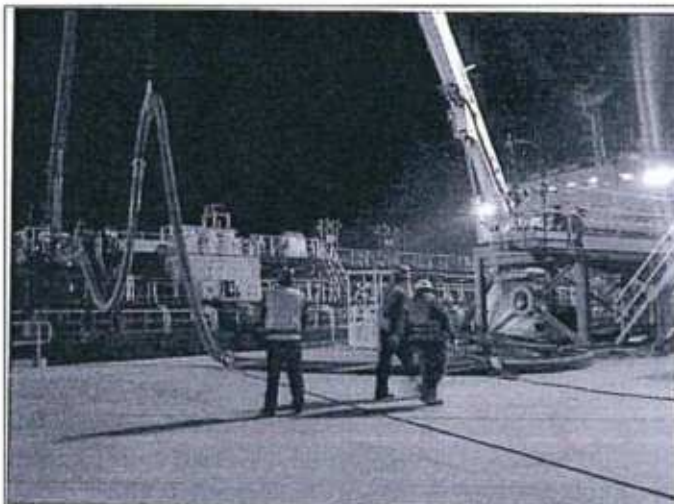
Fotografía N° 165: Embarque de ácido sulfúrico. No se observa el recipiente de PVC para atrapar los posibles goteos.
