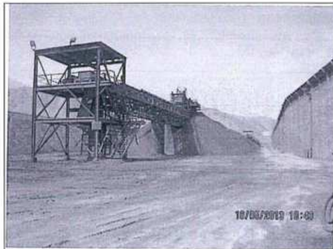
Fotografía N° 148: En el lado derecho se observa el muro construido para controlar la dispersión de concentrados por acción del viento.
