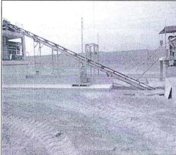
Foto 9.- Vista de la planta, sector molienda, chancado primario, secundario, se observa suelo removido como producto del paso de las unidades de transporte UTM WGS 84 E 293181 N 8673777 (...).
