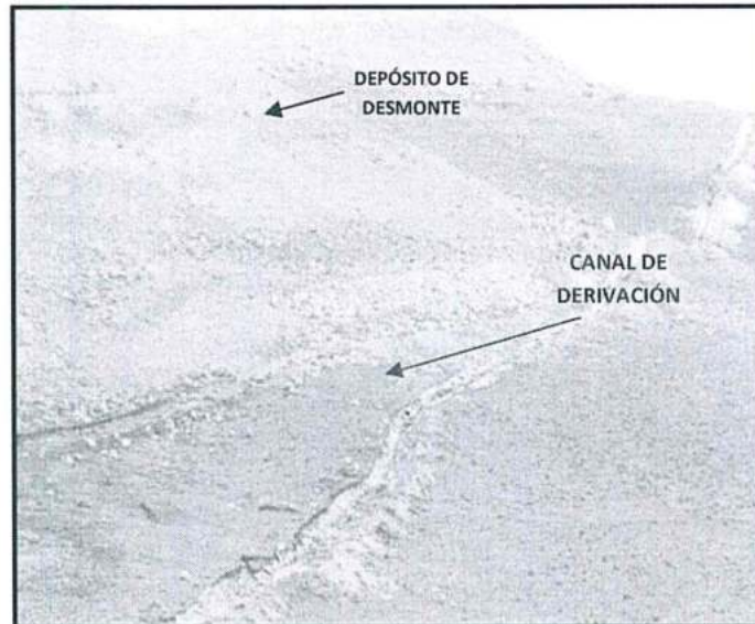
Fotografía N° 63. Cumplimiento de recomendación 6: Canal de derivación de botadero de desmote en todo el tramo de la zona Yanama recubierto con geomembrana.
