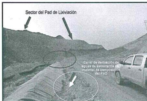
Fotografía N° 9: El material dispuesto en la parte inferior del Pad de lixiviación, no se encuentra perfilado cubriendo la berma de seguridad impermeabilizada con geomembrana que separa el PAD del camino de acceso y que separa al PAD del camino de acceso perimetral.
