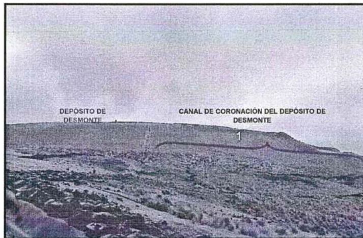
Fotografía N° 23: Vista cercana donde se aprecia que el canal de coronación del depósito de desmonte en el sector Yanama se encuentra inconcluso.
