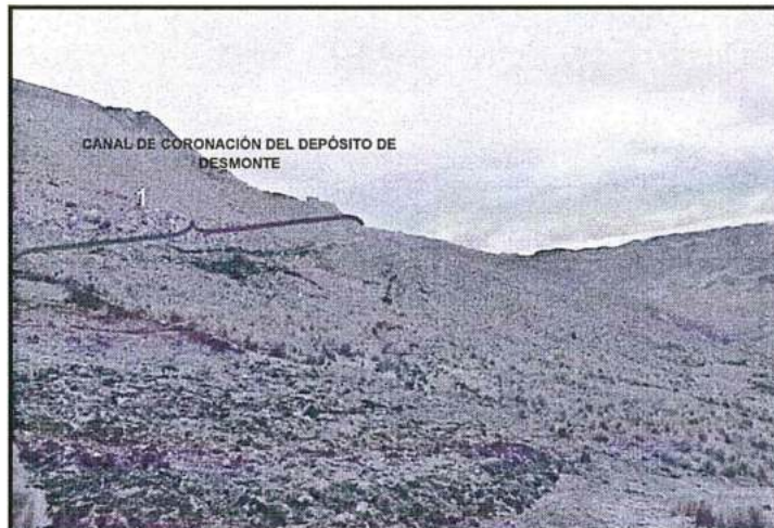
Fotografía N° 24: Otra vista donde se aprecia que el canal de coronación del depósito de desmonte en el sector Yanama se encuentra inconcluso.
