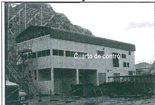
FOTOGRAFIA Nº 06-A.- Sala de control y subestación eléctrica: Foto tomada del reporte colgado en la página web de OSINERGMIN (Seguimiento de proyectos 2009). Se constató que la construcción estaba paralizada. Fecha de la verificación: 26 de enero de 2009.
