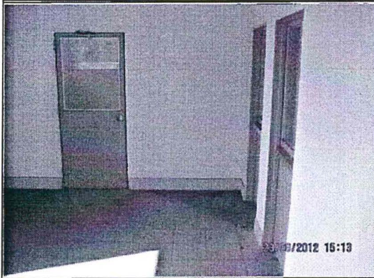
FOTOGRAFÍA N° 09.- Sala de control y subestación eléctrica: Vista de la infraestructura interna de la sala de control y subestación eléctrica. Las actividades de construcción/instalación se encuentran paralizadas. Fecha de verificación: 23 de agosto de 2012.
