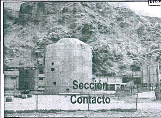
FOTOGRAFIA Nº 33-A.- Sección contacto: Foto tomada del reporte colgado en la página web de OSINERGMIN (Seguimiento de proyectos 2010). Se verificó que la construcción de la referida infraestructura se encontraba paralizada Fecha de la verificación: 20 de enero de 2010.
