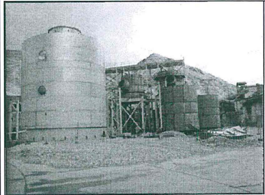
FOTOGRAFIA Nº 33-B.- Sección contacto: Las actividades se encuentran paralizadas desde el 15 de diciembre de 2008 (según reporte de supervisión de OSINERGMIN). Fecha de verificación: 29 de octubre de 2012.
